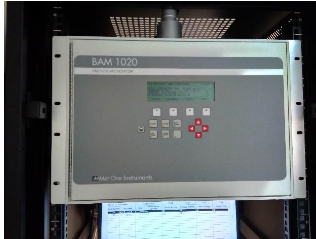
Figura 22. Equipo BAM1020 perteneciente a la estación de monitoreo.
