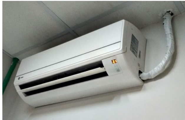
Figura 20. Equipo de aire acondicionado dentro de la estación.
