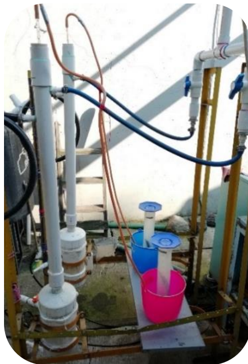
Figura 3. 14. Sistema de medición de biogás.
