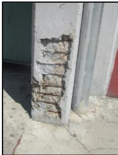
Figura 3.34 Pérdida de recubrimiento y corrosión del acero en la base de la columna del eje D. (DE-DICYG, 2018)
