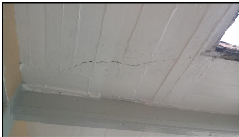
Figura 3.8 Daños intermedio. (CICM-SMIE, 2018)
