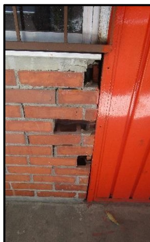
Figura 4.23 Daños no estructurales en muros divisorios de mampostería. (DE-DICYG, 2018)
