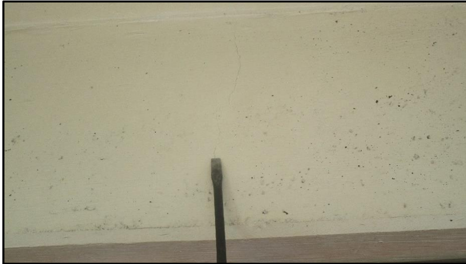
Figura 3.27 Grietas de tensión en trabe. (DE-DICYG, 2018)
