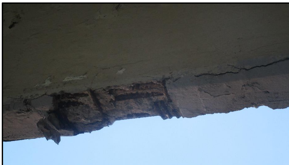
Figura 3.39 Pérdida de recubrimiento y corrosión en el acero, en pretiles. (DE-DICYG, 2018)
