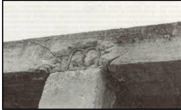
Figura 1.20 Desconchamiento del concreto en la unión viga-columna. (Temo Correa)
