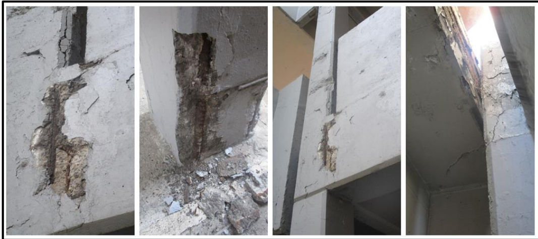
Figura 3.36 Daños por deterioro del concreto y corrosión del acero en la columna B4 (columna 32). (DE-DICYG, 2018)
