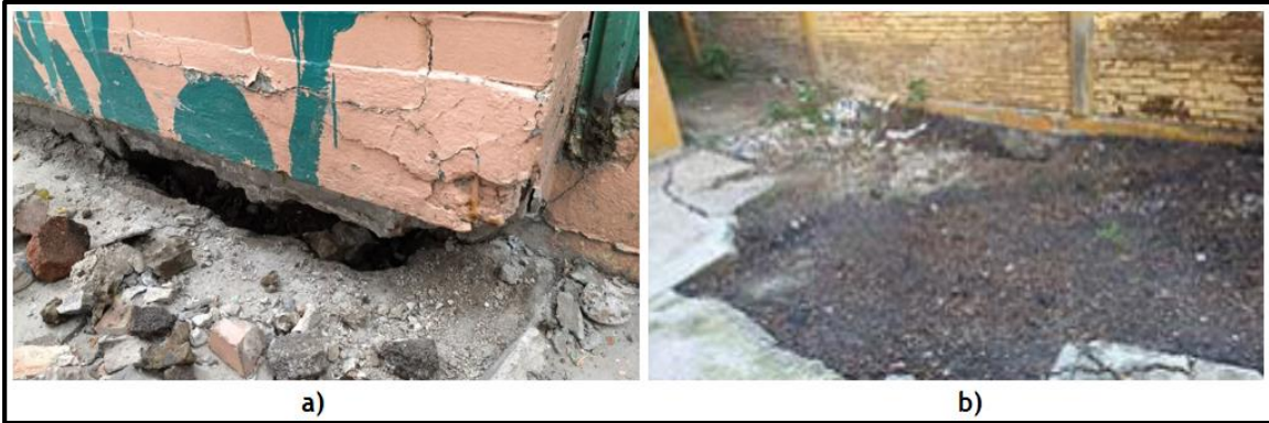
Figura 1.35 a) Asentamiento del terreno circundante b) socavación en esquina suroeste del plantel. (CICM-SMIE, 2018)
