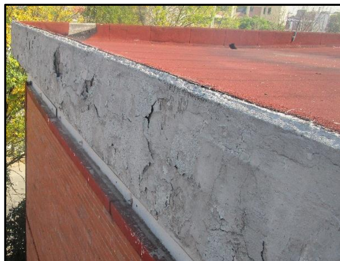
Figura 3.29 Daños preexistentes, deterioro del recubrimiento. (DE-DICYG, 2018)
