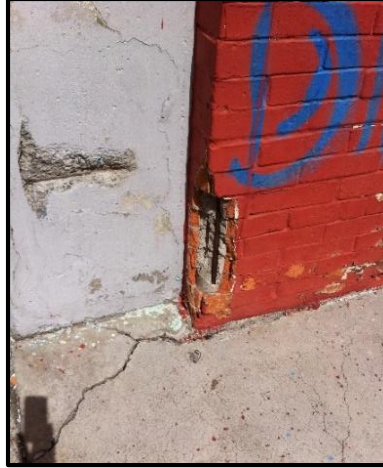
Figura 1.37 Pérdida del recubrimiento y exposición de acero confinado en muro de mampostería. (CICM-SMIE, 2018)
