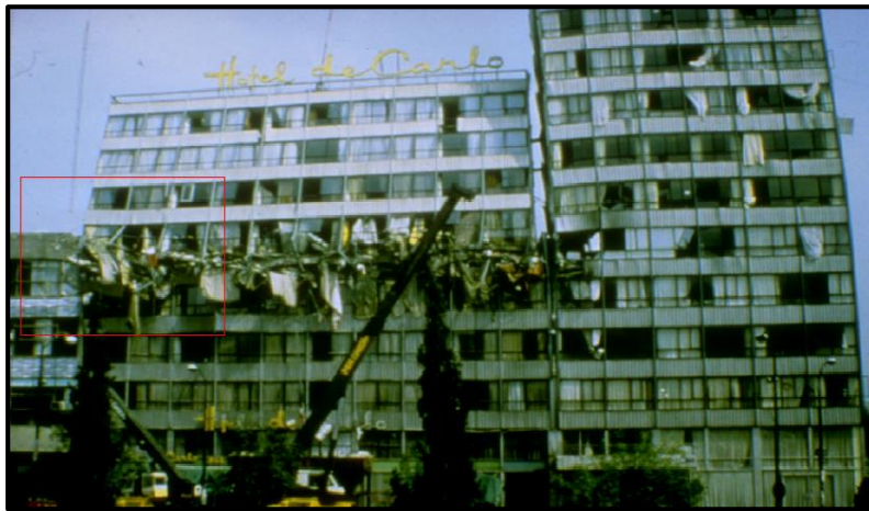
Figura 1.26 falla de entrepiso por golpeteo entre edificios adyacentes. (Bazán E. y Melí R., 1998)
