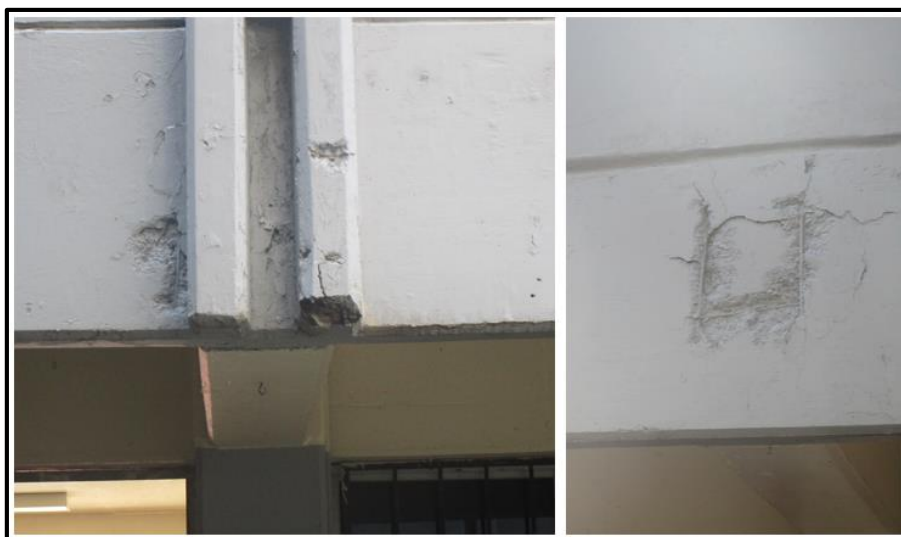
Figura 3.22 Daños preexistentes, deterioro del concreto y pérdida de recubrimiento debida a la corrosión del acero. (DE-DICYG, 2018)
