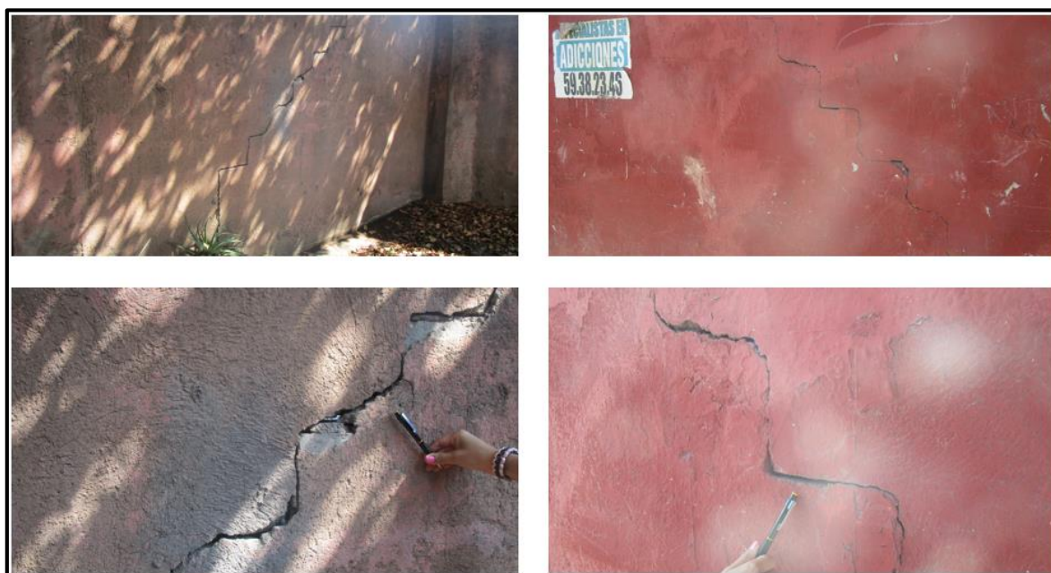
Figura 4.40 Daños en bardas por asentamientos diferenciales o desplomos. (DE-DICYG, 2018)
