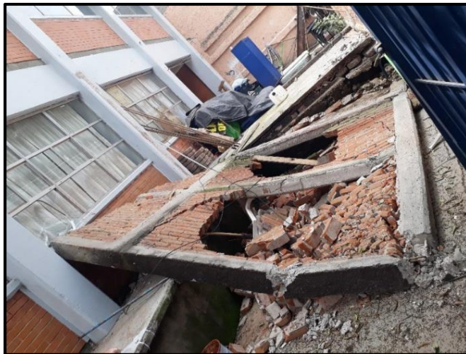
Figura 1.40 Derrumbe de muro de mampostería. (CICM-SMIE, 2018)
