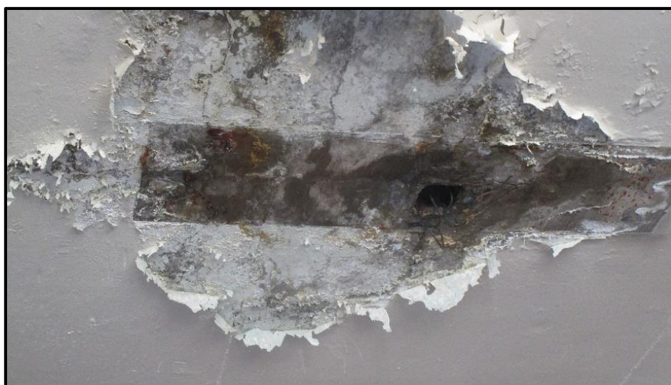
Figura 3.31 Daños por corrosión del acero debido a escurrimientos pluviales y falta de mantenimiento. (DE-DICYG, 2018)
