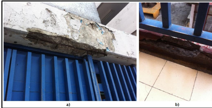
Figura 1.29 Daños en traves por deterioro del concreto y pérdida de acero, en las escuelas a) "Gral. Heriberto Jara" y b) "Juventino Rosas". (CICM-SMIE, 2018)
