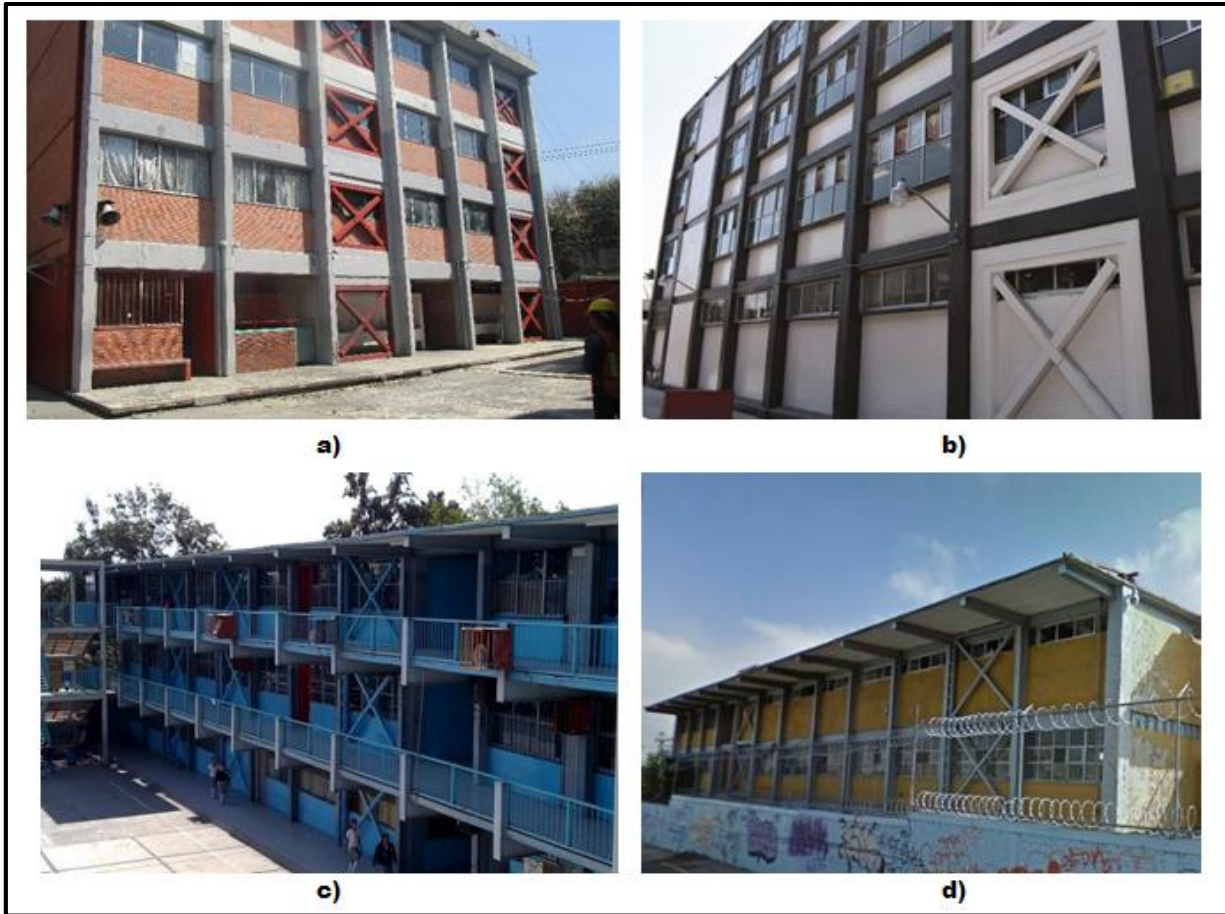
Figura 1.62 Contraventeos exteriores en las escuelas a) "Celestino Gorostiza"; b) "Dr. Manuel Gutiérrez Nájera"; c) "México Tenochtitlan" y d) "José María Velasco". (DE-DICYG, 2018; Notimex, 2017; Secundaria 275)
