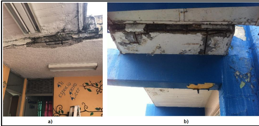
Figura 1.31 Daño en losas por corrosión del acero y pérdida de recubrimiento. (CICM-SMIE, 2018)
