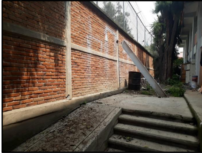
Figura 1.39 Pérdida de verticalidad (desplomo) en bardas. (CICM-SMIE, 2018)
