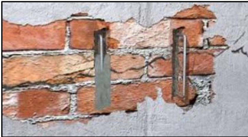
Figura 1.60 Reparación de grietas mediante grapas. (CYPE Ingenieros-Bolivia)
