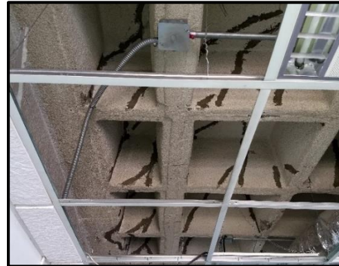
Figura 1.22 Grietas por efecto de cortante en las losas nervadas. (DE-DICYG, 2018)
