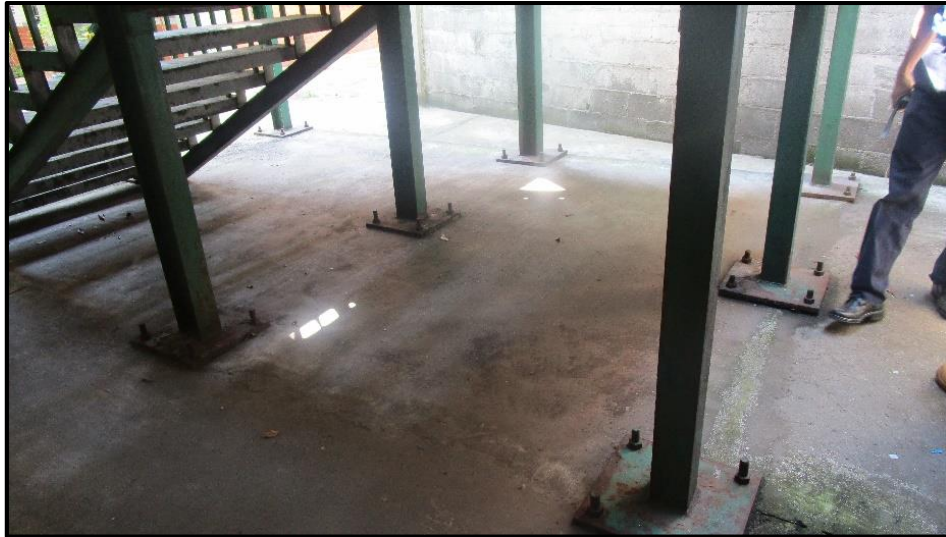
Figura 4.24 Falta de mantenimiento en la escalera metálica de emergencia, existencia de corrosión. (DE-DICYG, 2018)
