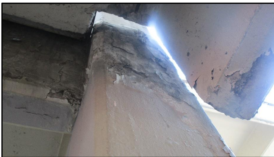
Figura 3.38 Deterioro del concreto, pérdida de recubrimiento en juntas constructivas y corrosión del acero debido a escurrimientos pluviales y movimientos relativos entre cuerpos. (DE-DICYG, 2018)
