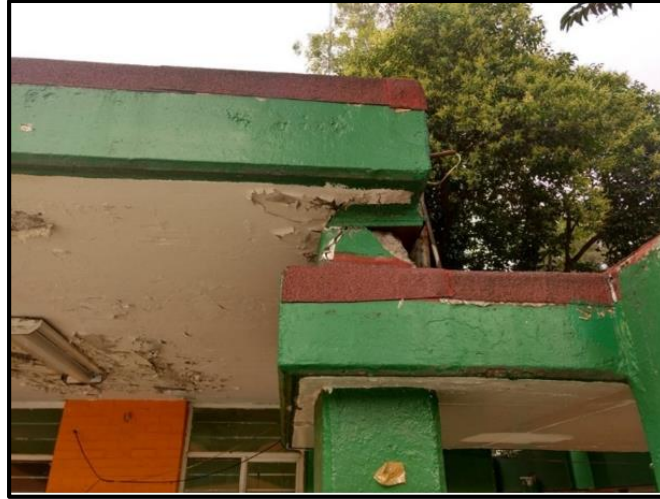
Figura 1.27 Daño en columna por efecto de columna corta. (CICM-SMIE, 2018)
