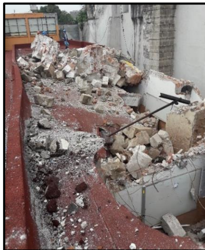
Figura 1.32 Derrumbe parcial de la losa de concreto. (CICM-SMIE, 2018)
