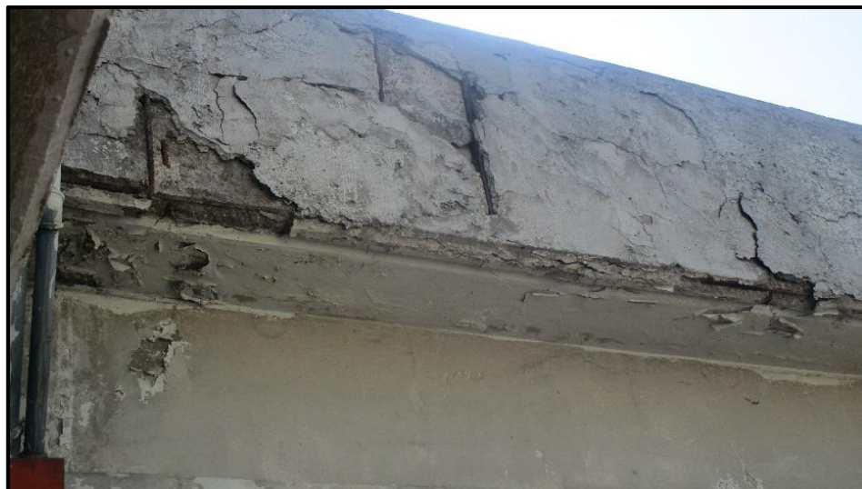
Figura 3.30 Daños por deterioro del concreto y corrosión del acero. (DE-DICYG, 2018)
