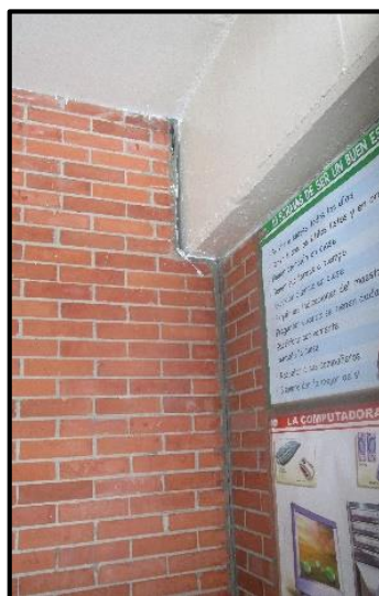
Figura 3.26 Daños en juntas de muros divisorios. (DE-DICYG, 2018)
