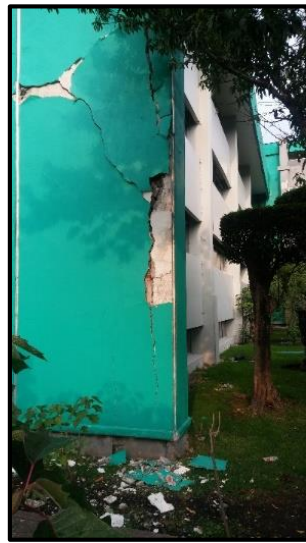
Figura 3.9 Daño grave. (CICM-SMIE, 2018)
