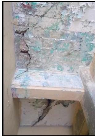
Figura 1.30 Grietas por tensión diagonal en losa de concreto. (CICM-SMIE, 2018)
