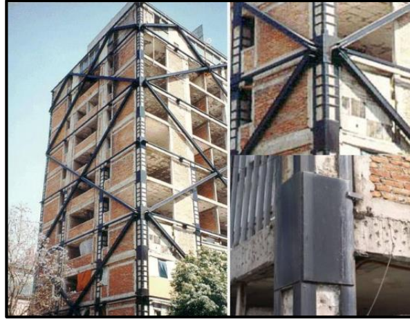
Figura 1.49 Edificio con contraventeos y encamisados de columnas. (AF-CENAPRED)
