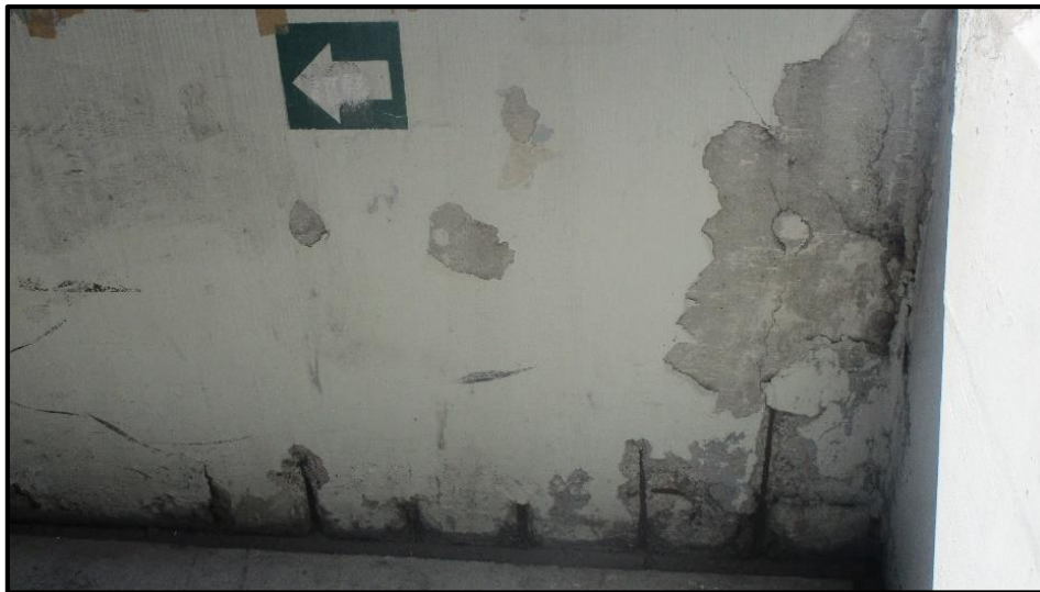
Figura 3.37 Deterioro del concreto y corrosión del acero en muro. (DE-DICYG, 2018)
