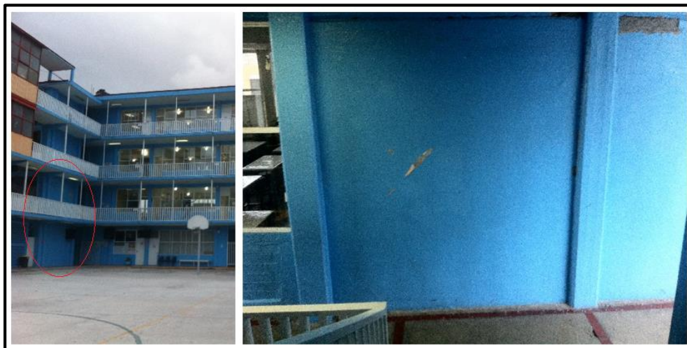
Figura 1.34 Grietas por fuerzas cortantes en la Esc. Primaria "Republica De El Salvador". (CICM-SMIE, 2018)
