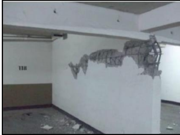
Figura 1.23 Efecto en muro transversal. Edificio Sol Oriente, Santiago. (SciELO.org)
