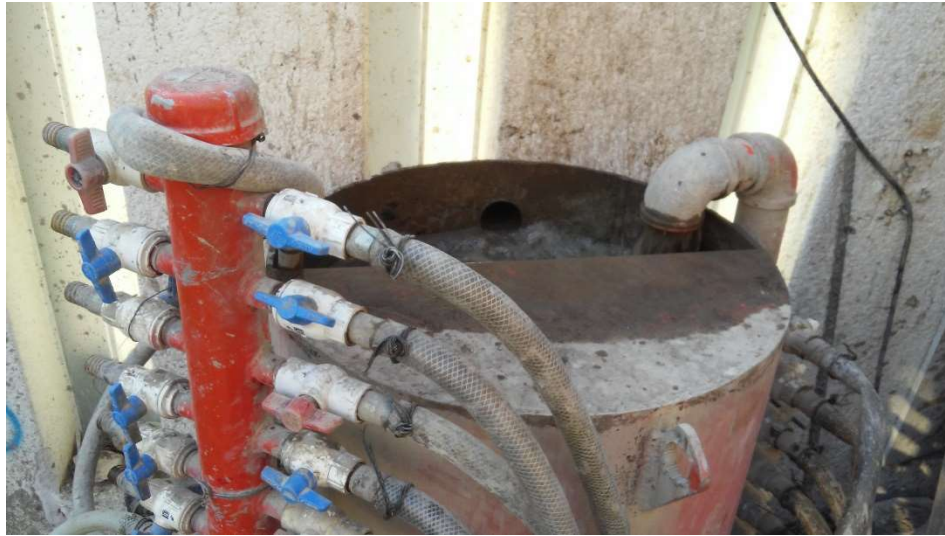
Imagen 11. Captación y almacenamiento de nivel freático.
