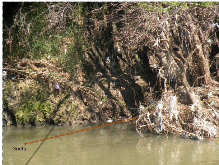
Figura 6.4. Fotografía al Norte del río Apatlaco donde una grieta de \pm 1 m de desplazamiento vertical, produce el colapso local de un bloque hacia el río.
