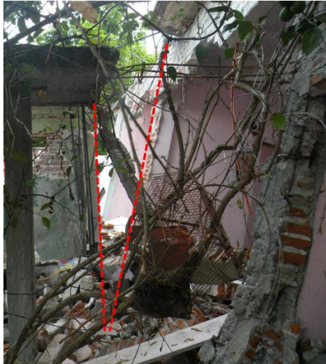
Figura 6.1. Fotografía donde se observa la inclinación de la estructura parcialmente colapsada al sur de la colonia Lázaro Cárdenas, lo cual pudo haber sido causado por licuefacción.
