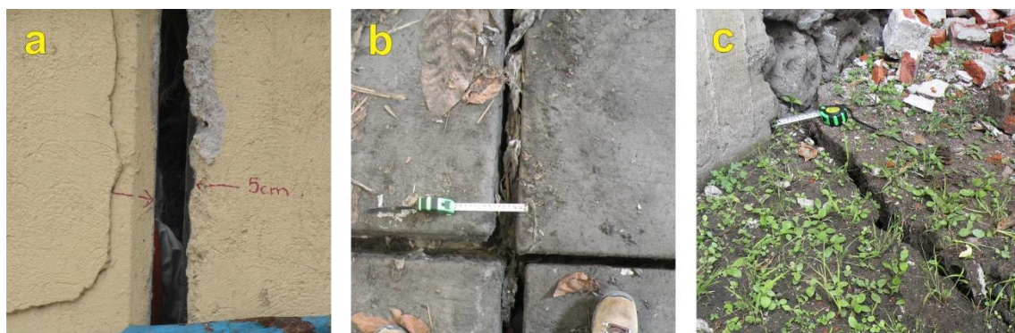
Figura 5.8. Fotografías de grietas de 7 a 8 cm de extensión, la cuales coinciden con la diferencia de desplazamientos observada en el mapa de subsidencia de la Figura 5.7.
