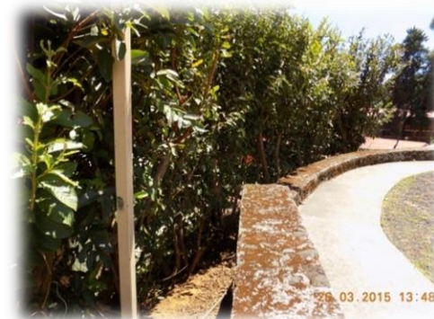
En esta parte observamos un elemento que obstruye el paso de peatones, ya que después del murete, el terreno sufre un desnivel bastante considerable que pone en peligro el paso de los usuarios.
