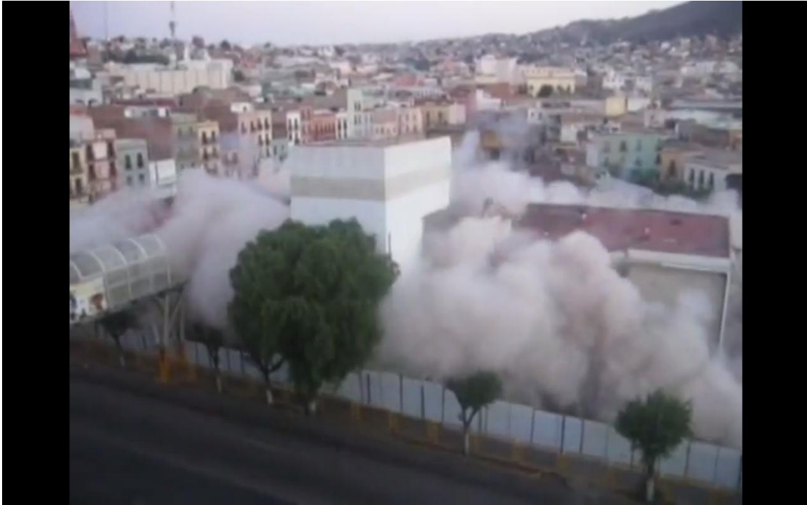
Ilustración 10 En el año 2008 demuelen el Centro de Transferencia de Autobuses Urbanos y Plaza comercial, fuente: información obtenida de https://plazesyjardinesdezacatecas.blogspot.com/2011/02/plaza-bicentenario.html?m=1
