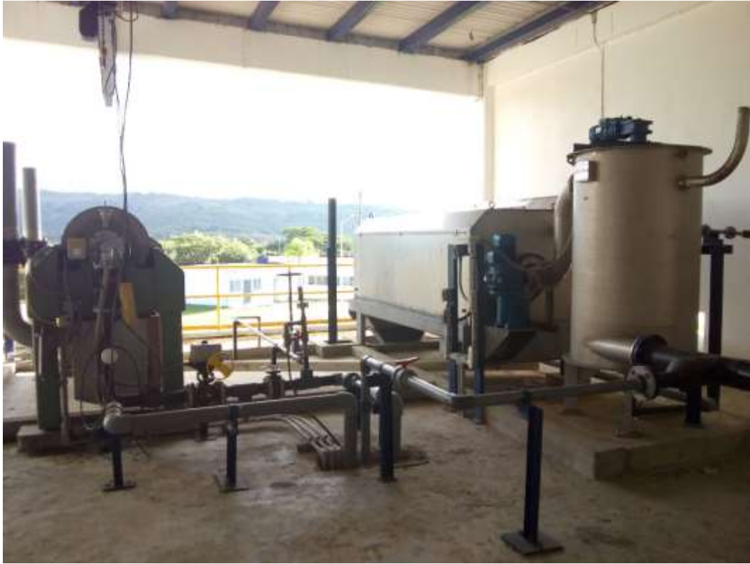
Figura 30. Sistema de espesamiento de lodos
