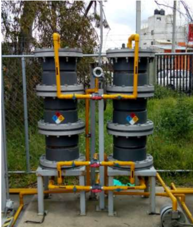
Figura 50. Filtros para la remoción de H 2 S
