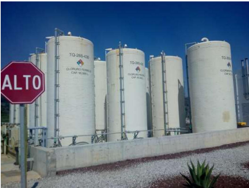
Figura 38. Silos de cloruro férrico con capacidad de 90,000 L
