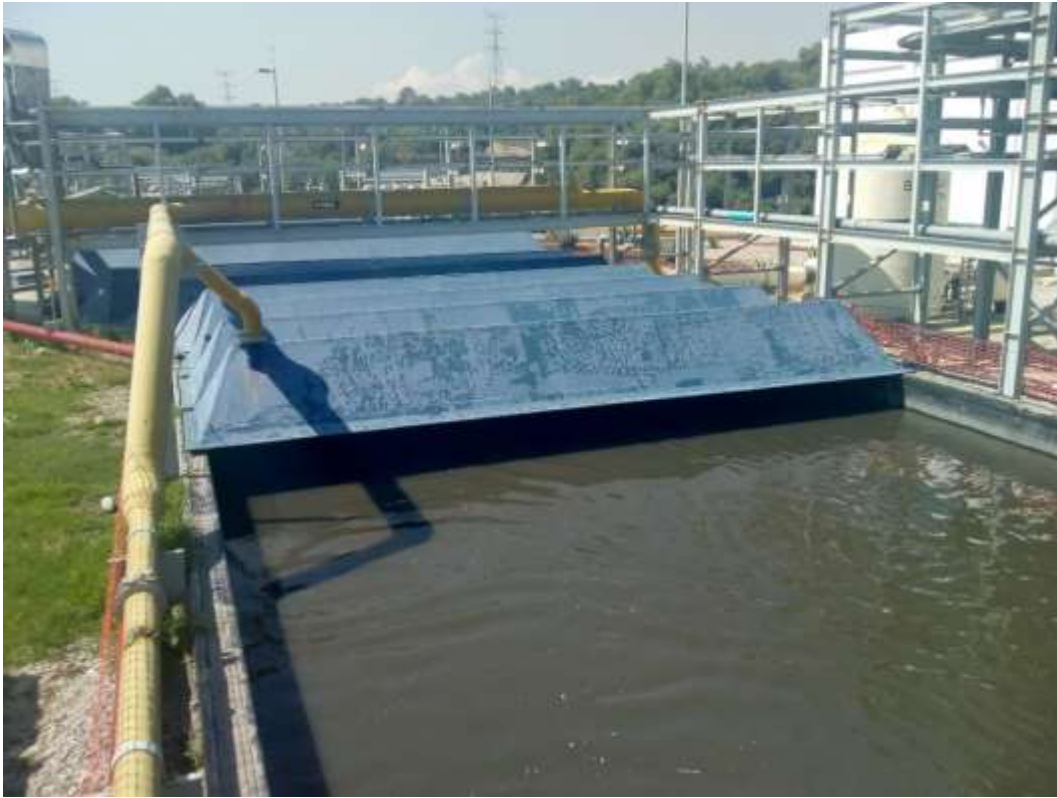
Figura 37. Canal de entrada al proceso fisicoquímico
