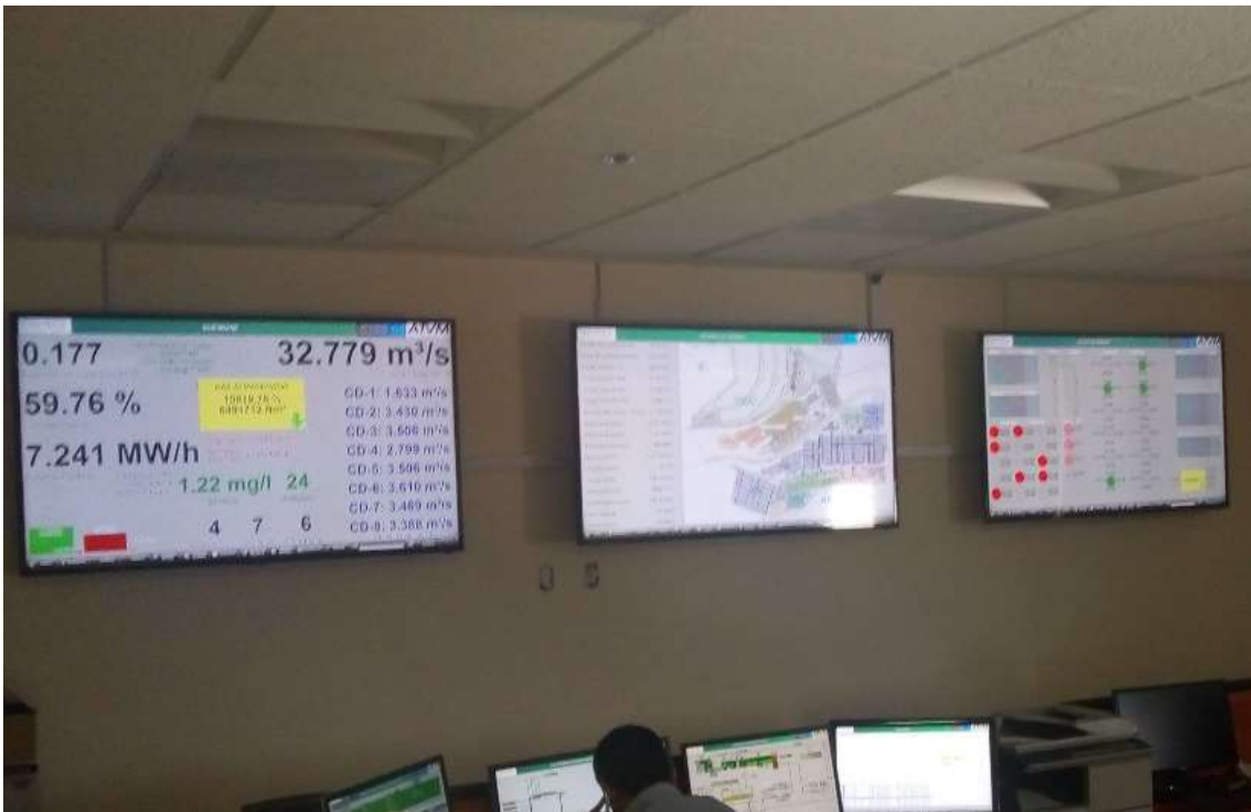
Figura 42. Cuarto de control
