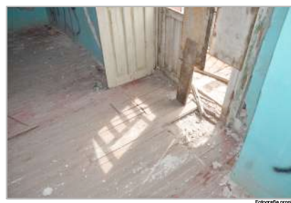
Resqueadad, pérdida de piezas y guano de paloma en piso de madera
