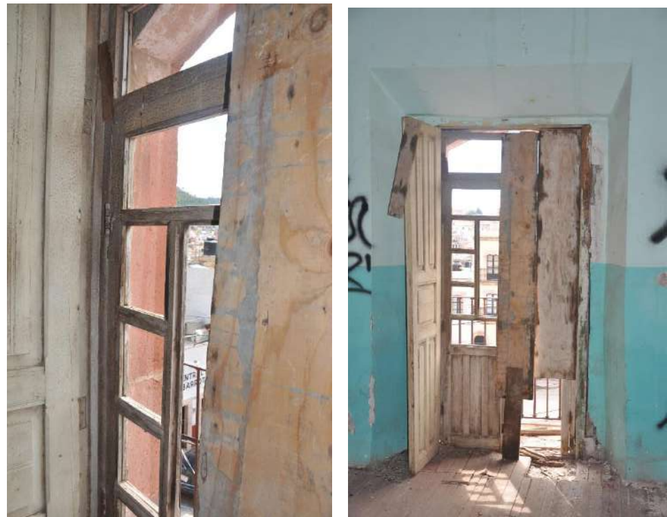
Ilustración 79 Deterioros en ventanas de madera presentes en el caso de estudio. Fuente: fotografías propia.
