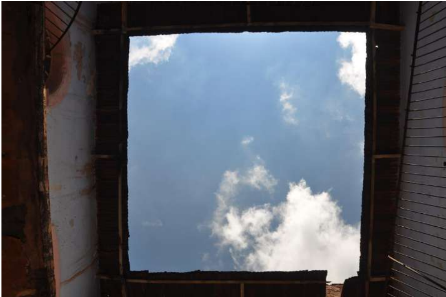
Ilustración 68 Imagen de cubierta de lámina corrugada, presente en el caso de estudio. Fuente: fotografía y elaboración propia.
