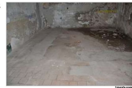
Humedad, pérdida de piezas y basura en piso de piedra
