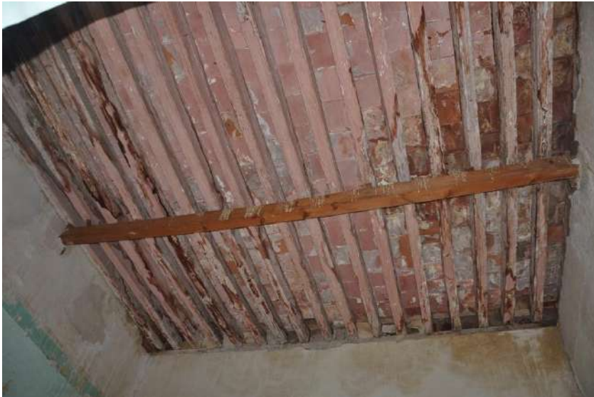
Ilustración 76 Humedad y resequeidad en losa a base de vigas de madera presente en el caso de estudio. Fuente: fotografía propia.
