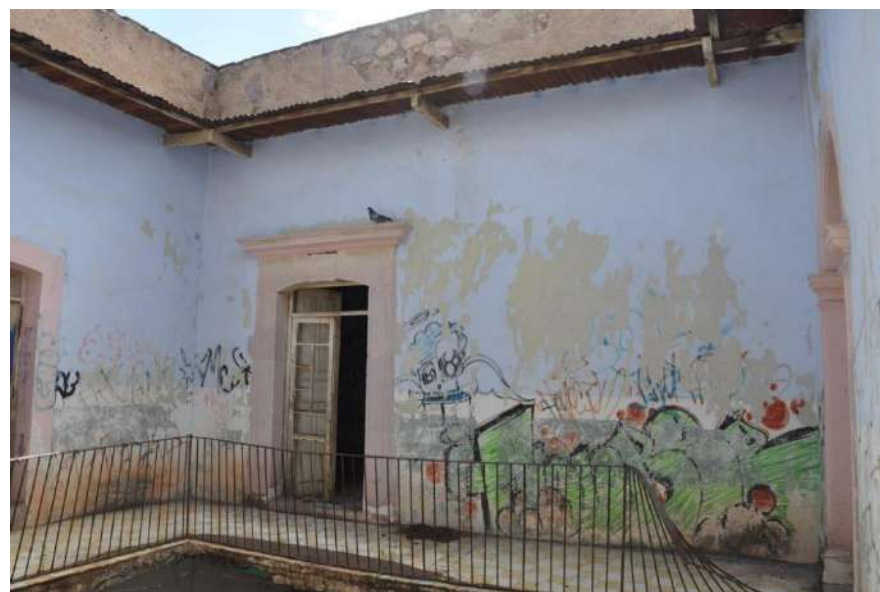
Ilustración 75 Pintas vandálicas y pérdida de aplanados presentes en el caso de estudio. Fuente: fotografía propia.
