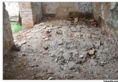
Escombros de entrepiso
