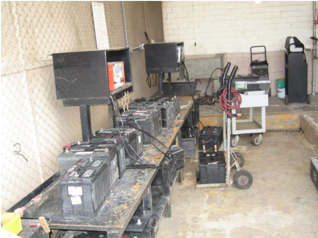
AREA DE CARGA DE BATERIAS
