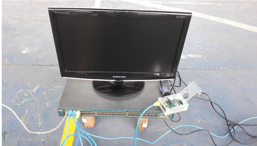
Figura 5.9: Switch ethernet utilizado para recibir información de los dispositivos receptores.
