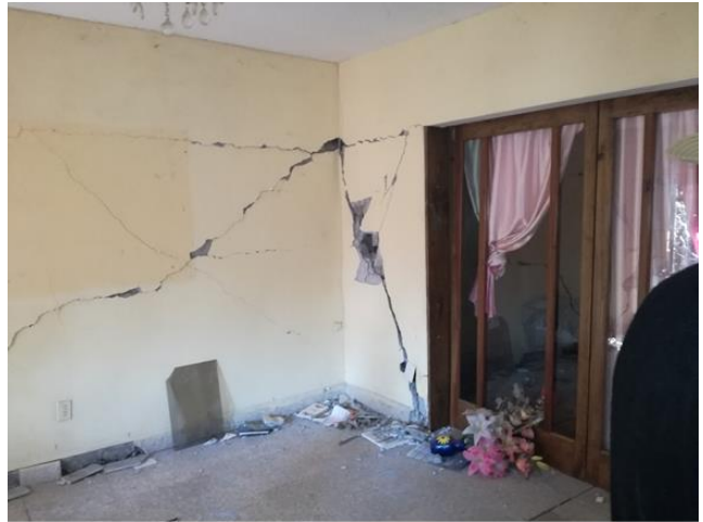
VISTA DE MUROS CUARTEADOS MENOS EN TRABES
