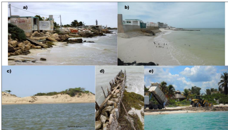
Figura 2. Daños causados por erosión costera.
