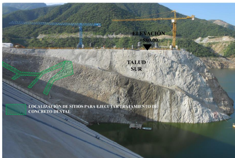
Figura 46. Proyección de sitios donde se ejecutaron tratamientos de concreto dental, vista lateral del Talud Sur del espolón de roca, (CFE, septiembre 2014).
