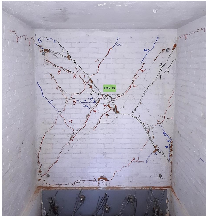
Fig. 3.60. Estado final de daño en muro central de primer nivel en fachada norte (eje B)
