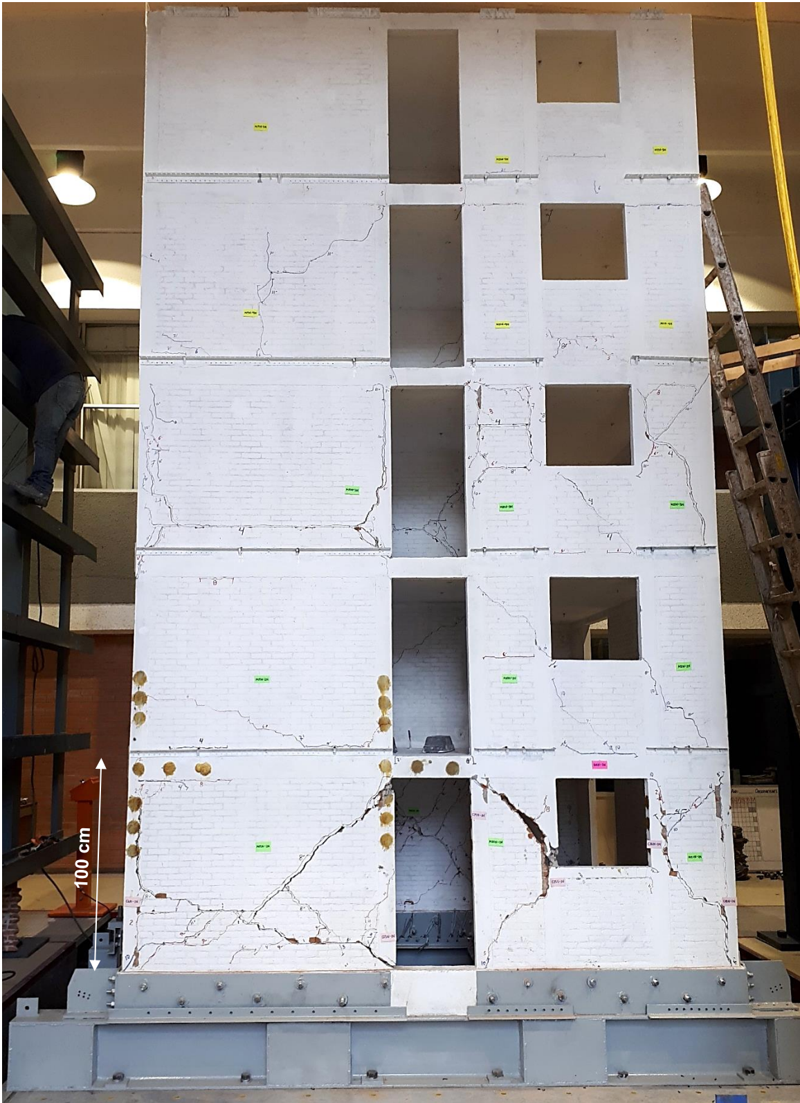
Fig. 3.50. Estado final de daño en la fachada norte (eje A)
