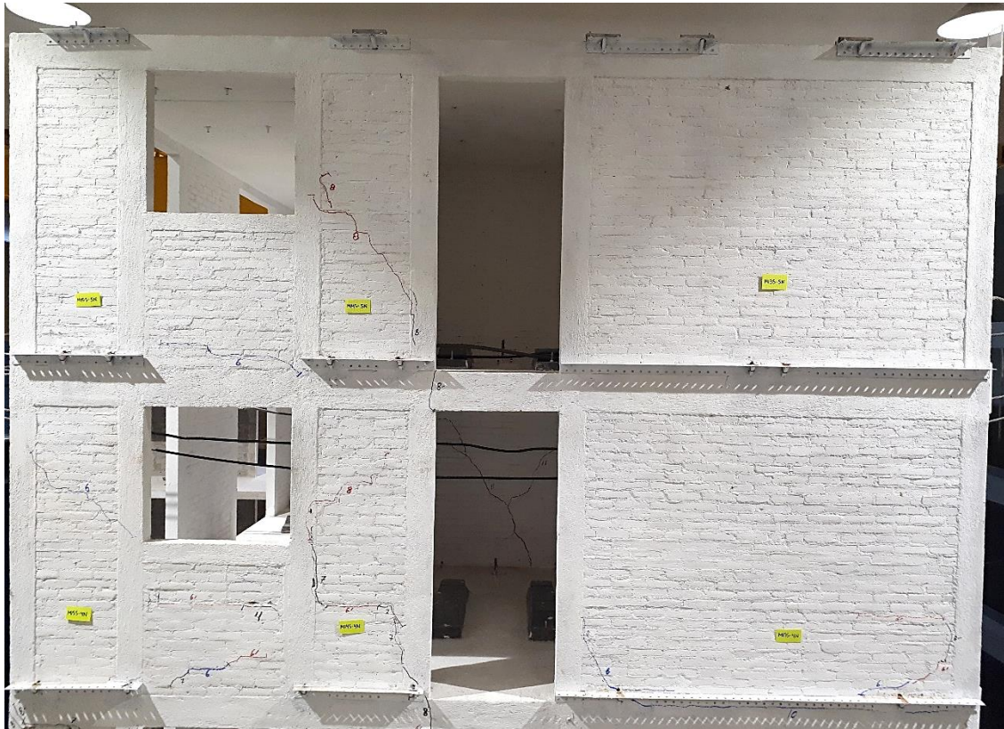
Fig. 3.58. Estado final de daño en cuarto y quinto nivel de fachada sur (eje C)
