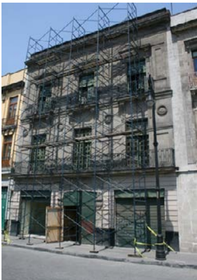
-Se puede observar que la fachada no presenta grandes daños como en su interior-
