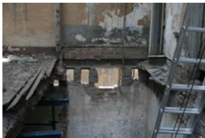
-Foto de uno de los pisos superiores al interior del inmueble, en él se observa el grado de deterioro en el que se encuentra -
