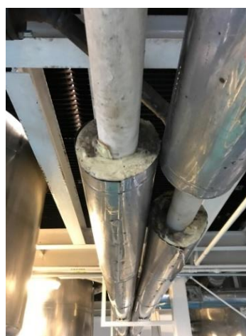
Figura 4.3 Tubería sin aislante
