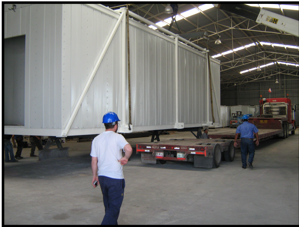
Terminación - Foto 4. Eslingas estiradas y el contenedor trabajando estructuralmente como fue proyectado. En el izaje se utilizaron dos grúas de 30 ton.
