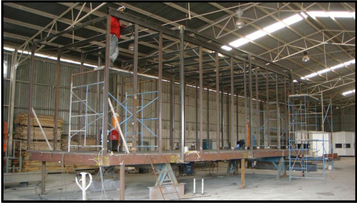
Construcción - Foto 2. Integración de marcos ligeros para muros y techo con marcos rígidos según diseño aprobado para fabricación.
