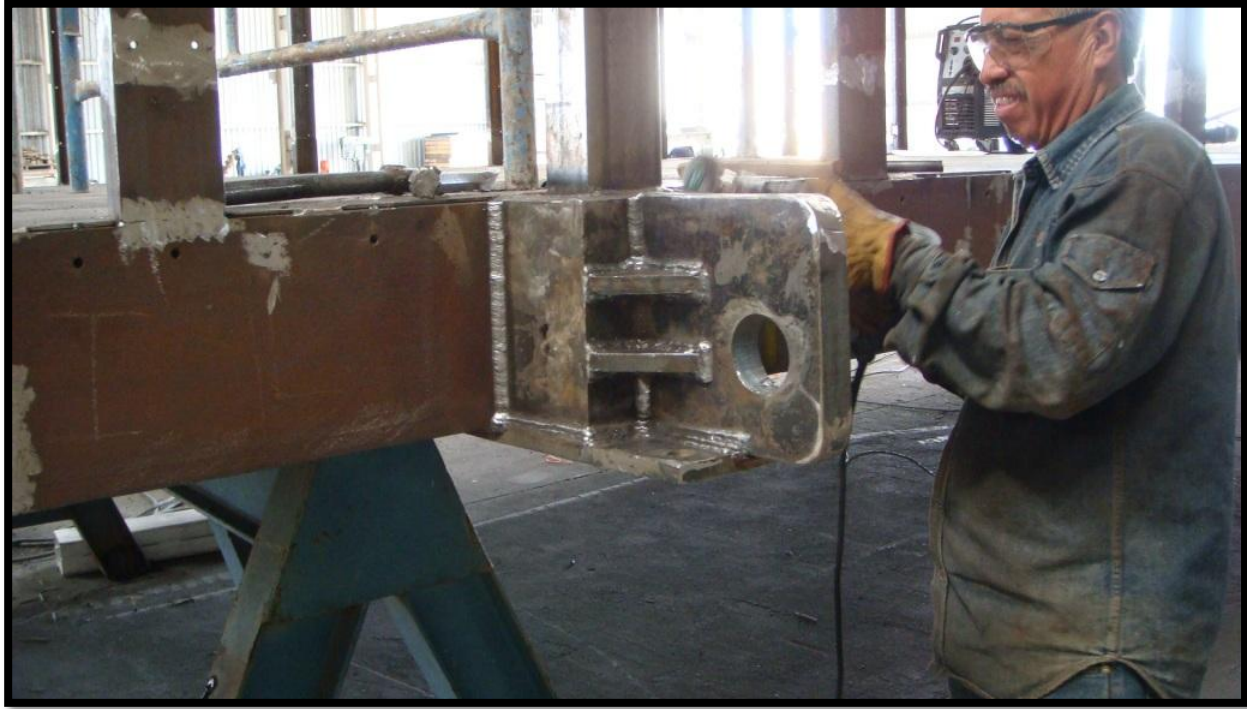
Construcción - Foto 4. Construcción de las orejas de izaje. Nótese la longitud efectiva de soldadura, misma que une la placa base de \frac{3}{4} ", la propia oreja y su caja de 1 \frac{1}{2} ", la base del marco rígido embebida en la caja de la oreja, el cordón de la caja de la oreja a la canal perimetral de 10" y finalmente, los dos cartabones a cada lado. Este solo arreglo, según el cálculo, soportaba mas de 50 ton.
