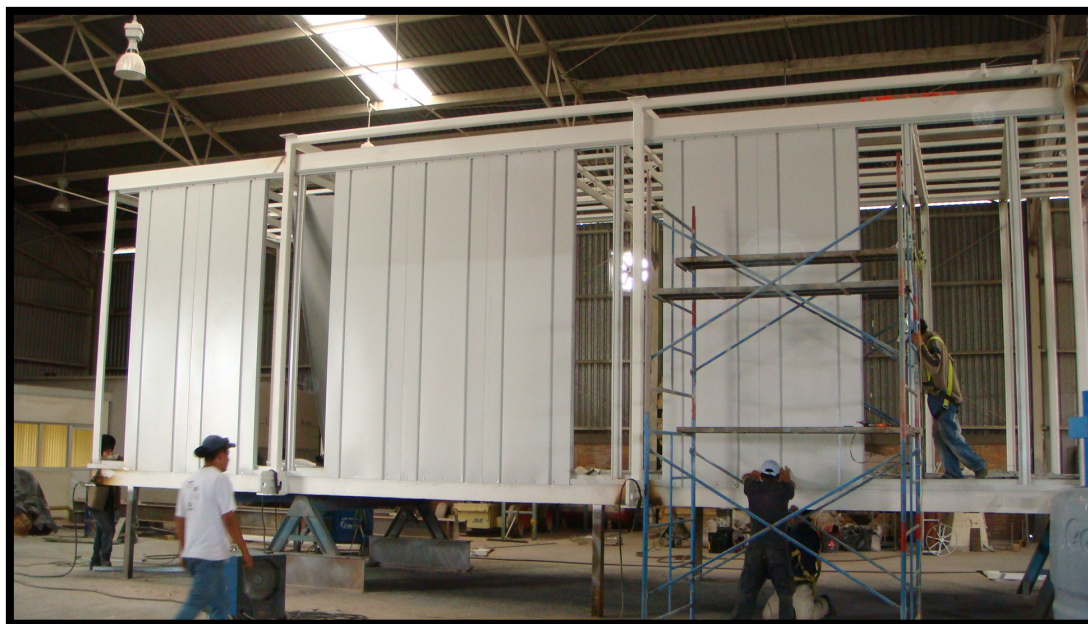
Construcción - Foto 10. Ensamble de paneles de muro. Cabe mencionar que los muros llevaron como aislamiento lana mineral de roca de 43 kg/m 3 .
