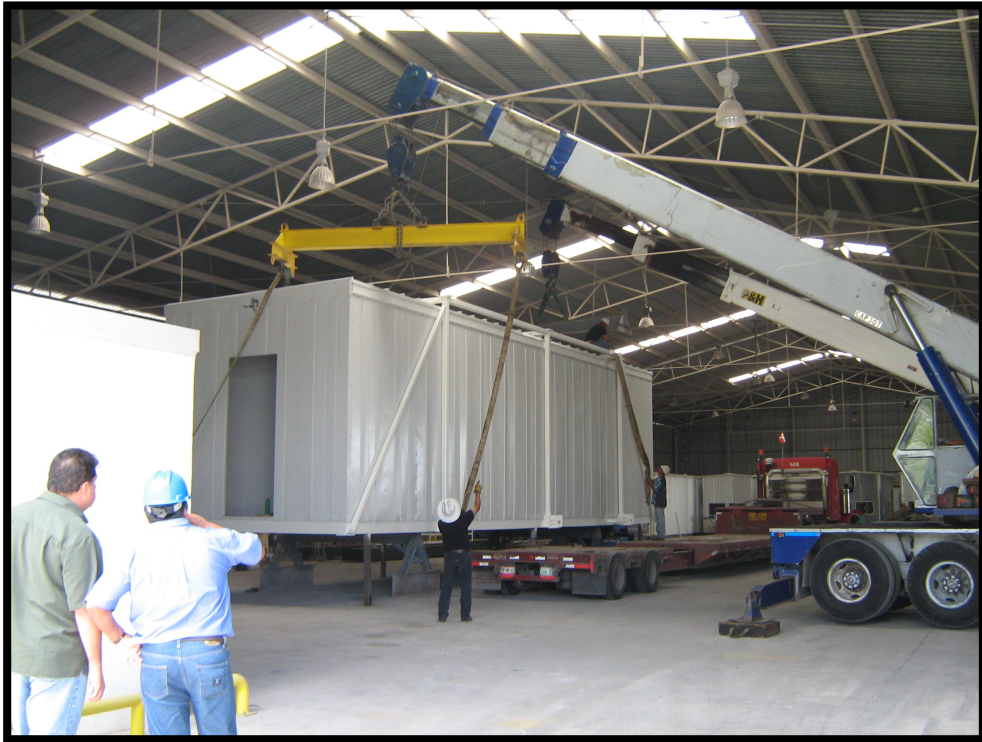
Terminación - Foto 3. Preparación de eslingas para carga de la caseta en la plataforma low-boy.
