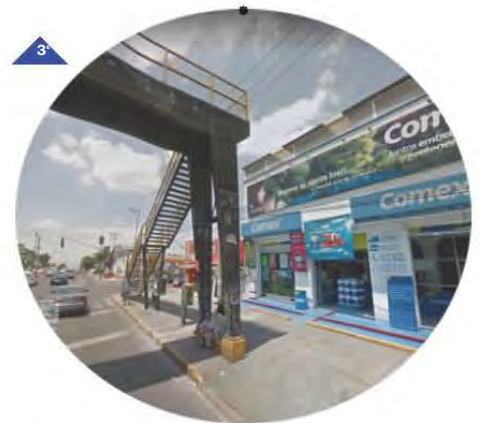
3 La falta de parada, hace que los peatones otorguen ese uso a la estructura del puente.
