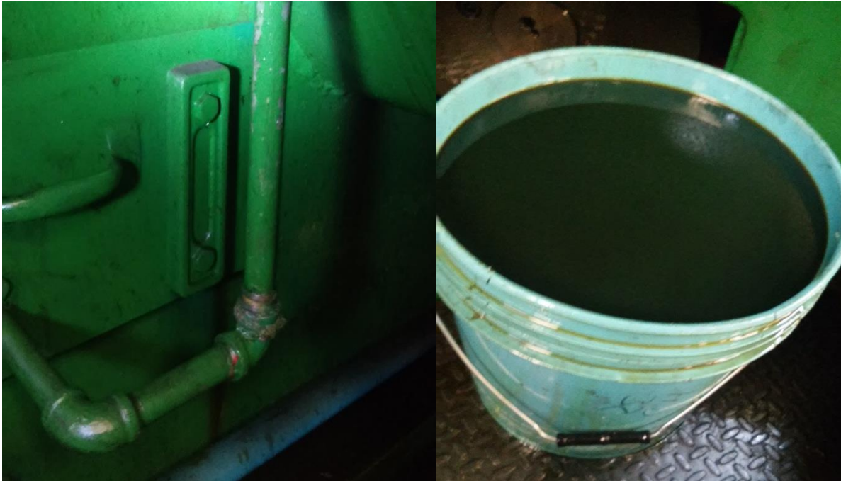
Figura 20. Problema generado por la falta de visibilidad en el nivel de aceite. Fuente: cortesía de la organización.
