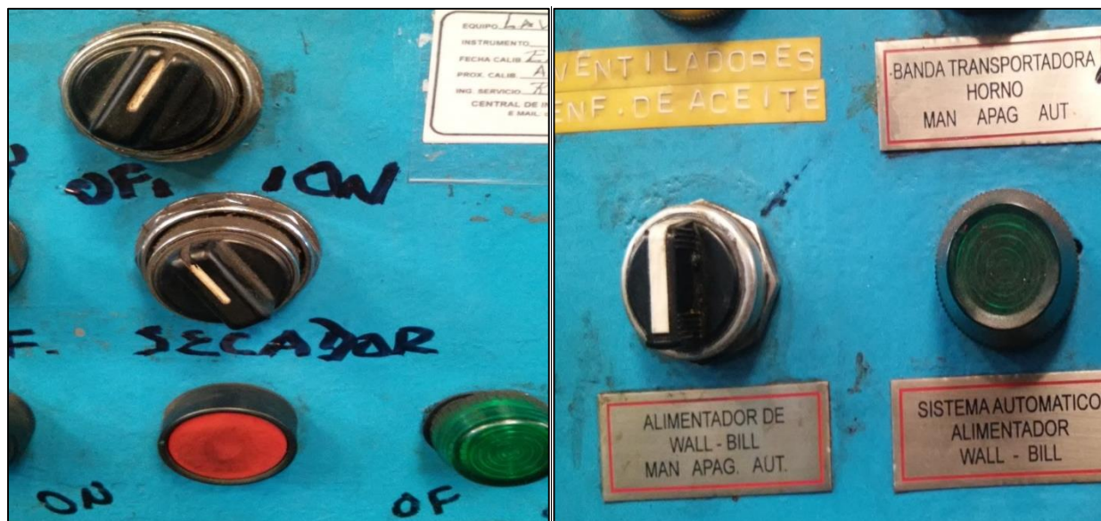
Figura 19. Antes y después de colocar las placas de identificación a los tableros de control de los hornos de temple y revenido. Fuente: cortesía de la organización.
