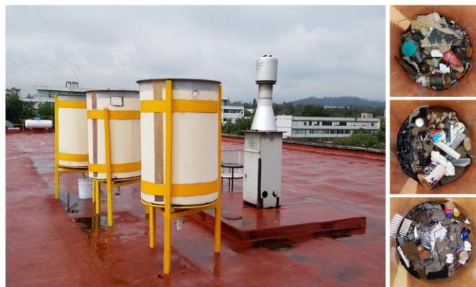
Fig. 4.7 Captación de agua pluvial
