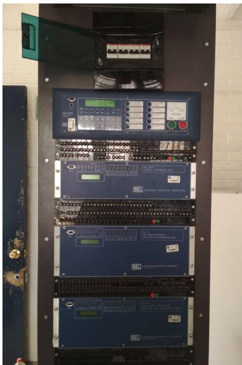
Figura 87. Presentación de equipos y componentes montados en gabinete. Nota: En ella se muestra todos los equipos SEL con sus respectivos paneles, además contando con el centro de carga, todos ellos fijados y montados correctamente.
