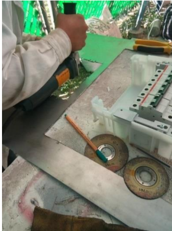
Figura 33. Desbaste del corte asignado para el empotramiento del centro de carga. Nota: En ella se muestra el proceso de desbaste para el empotramiento correcto del centro de carga.
