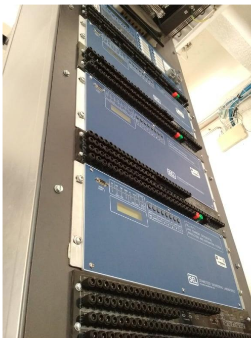
Figura 88. Presentación de gabinete con equipos montados vista angular 2. Nota: En ella se muestran a los equipos SEL montados al gabinete.
