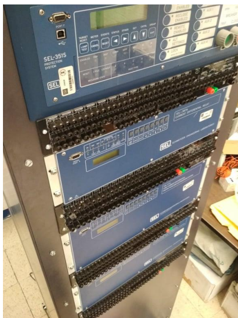
Figura 83. Presentación de equipos SEL montados en gabinete.
