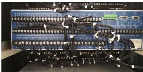
Figura 73. Cableado final SEL-387A.
