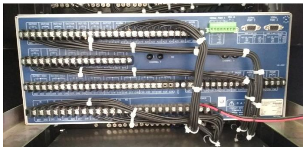
Figura 74. Cableado final SEL-311L.
