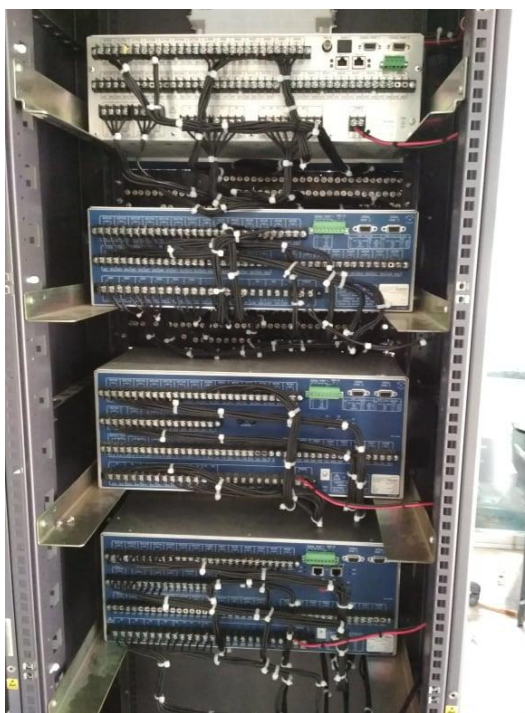
Figura 90. Presentación de cableado final 2.
