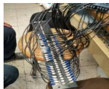
Figura 68. Proceso de cableado SEL-387A. Nota: En ella se muestra el proceso de cableado entre las terminales de entrada y salida, hasta los conectores montados sobre los paneles de policarbonato del equipo SEL387A.
