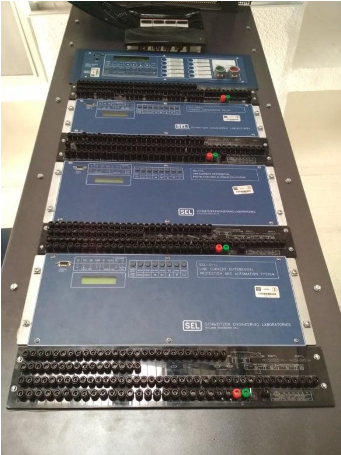
Figura 91. Presentación de gabinete con equipos montados vista angular 3. Nota: En ella se muestran a los equipos SEL montados al gabinete.
