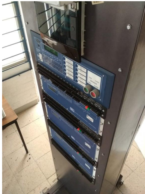
Figura 86. Presentación de gabinete con equipos montados vista angular. Nota: En ella se muestran a los equipos SEL montados al gabinete.
