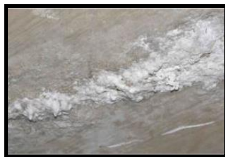
Figura 6.7. Eflorescencia en losas.
