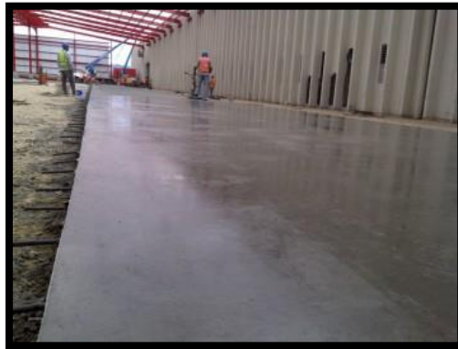
Figura 6.11. Sangrado en piso de concreto.
