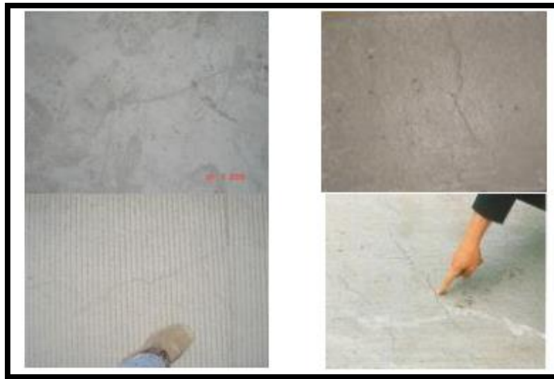
Figura 6.1. Fisuras por contracción plástica.
