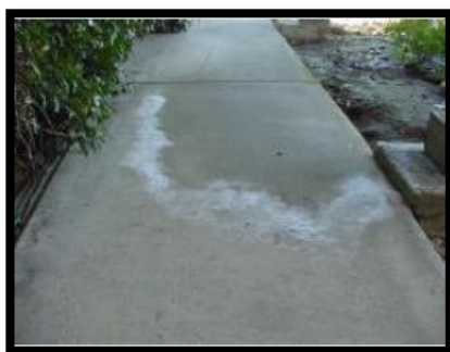
Figura 6.6. Eflorescencia en pisos.
