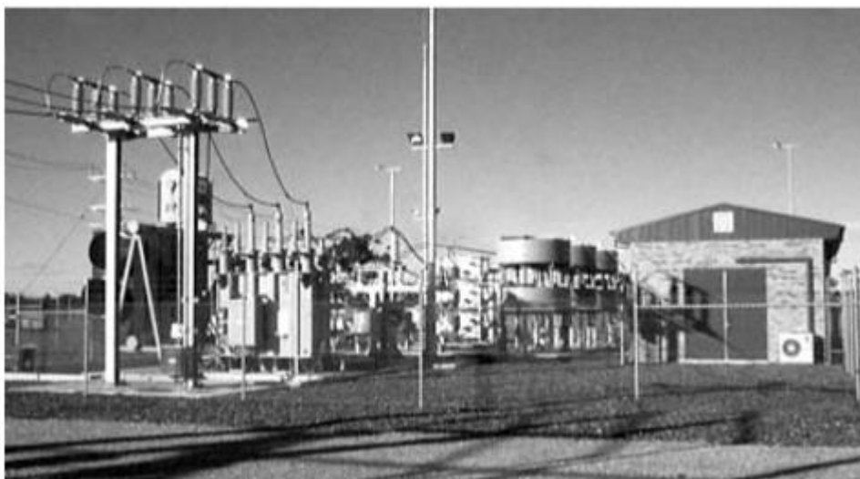
Figura 2.19. SVC fabricado por Alstom de +30/-25 MVAR en 66 KV.
