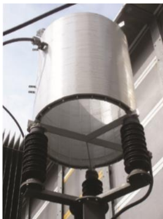
Figura 3.5. Reactor de aterrizamiento de neutro tipo seco.
