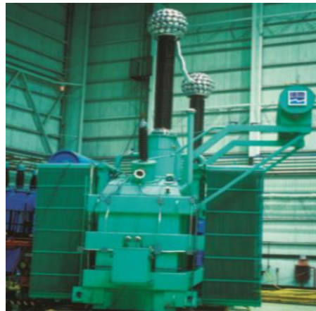
Figura 1.23. Reactor de potencia.
