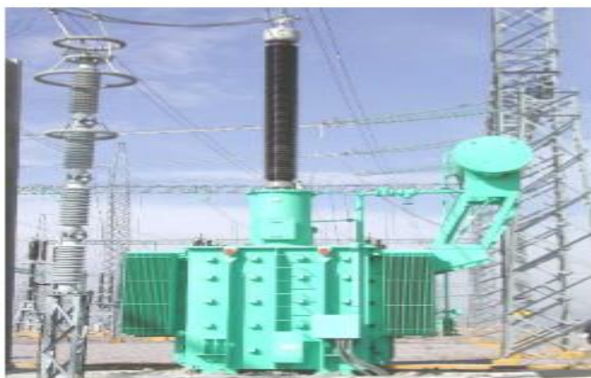
Figura 3.6. Reactor monofásico sumergido en aceite.
