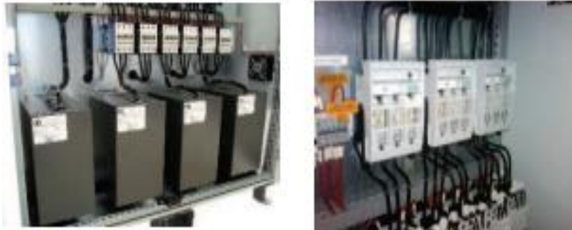
Figura 1.21. Ejemplo de banco de capacitores.
