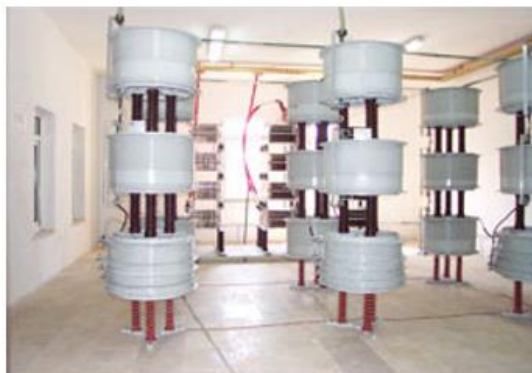
Figura 3.2. Reactores tipo seco.
