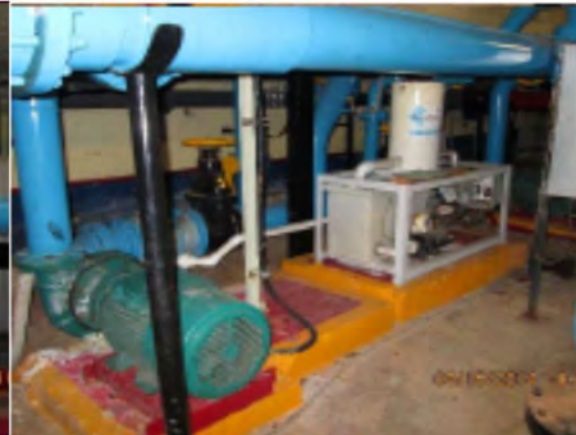
Bombas/ Cuarto de máquinas alberca
