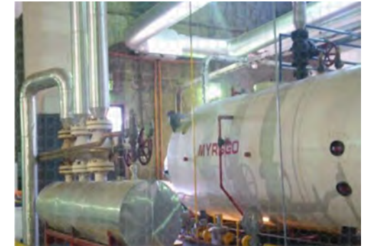
Cuarto de máquinas /2017 /caldera/alberca unam
