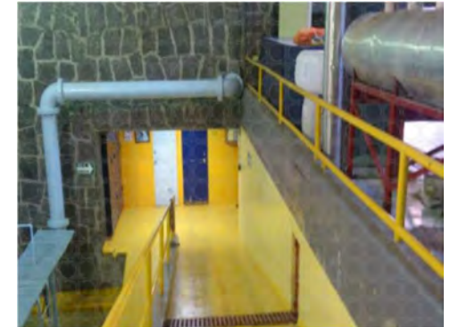
Cuarto de máquinas /2017 /lockers y sanitarios/alberca unam
