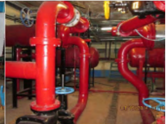
Tubería de agua caliente/ Cuarto de máquinas
