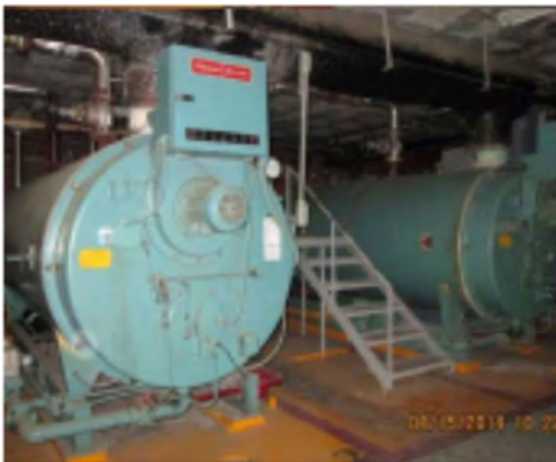
Caldera/ Cuarto de máquinas
