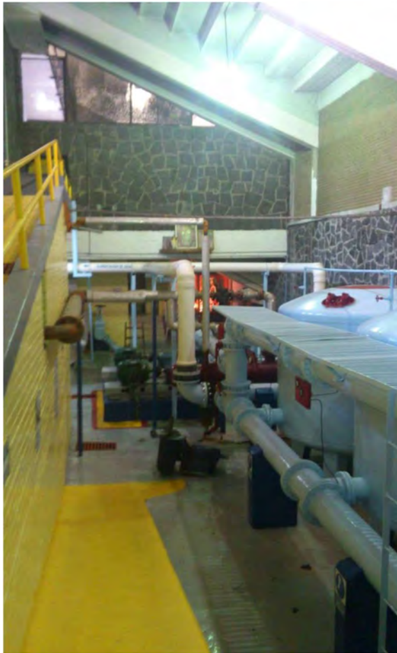
Cuarto de máquinas /2017 /motobombas/alberca unam
