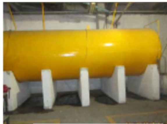
Caldera / Cuarto de maquinas
