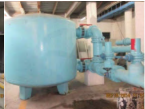
Filtros / Cuarto de maquinas
