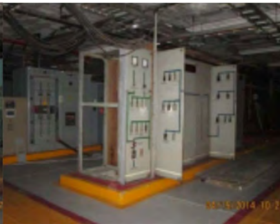
Subestación / Cuarto de máquinas alberca
