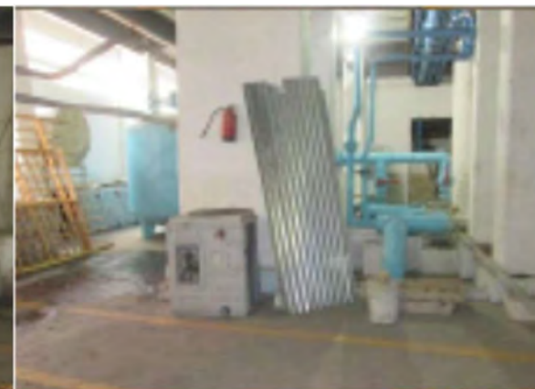
Cuarto de maquinas
