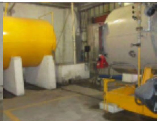
Cuarto de maquinas
