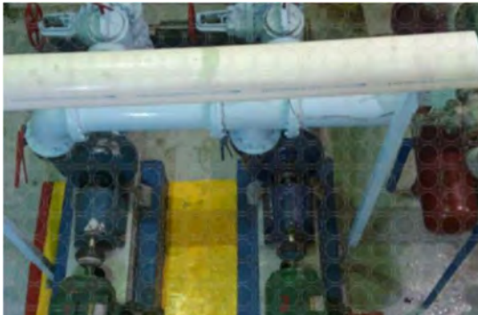
Cuarto de máquinas /2017 /motobombas/ alberca unam
