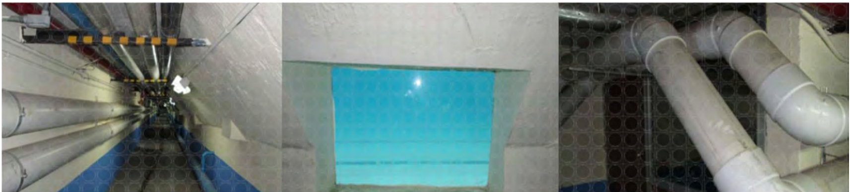
Tubería / paso perimetral alberca francisco Márquez
