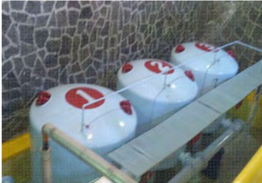
Cuarto de máquinas/ filtros /2017 alberca unam
