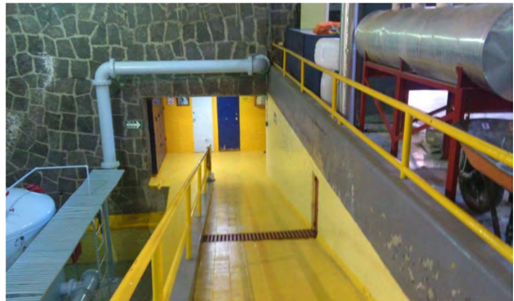
Cuarto de máquinas /2017 /rampa / alberca unam
