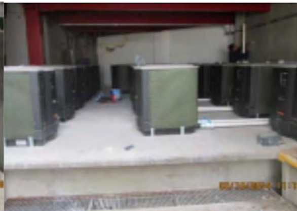
Bombas de calor / Cuarto de maquinas
