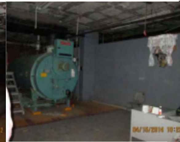
Caldera con control de vigilancia / Cuarto de máquinas alberca
