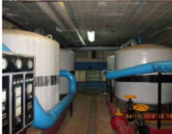
Filtros/ Cuarto de máquinas alberca
