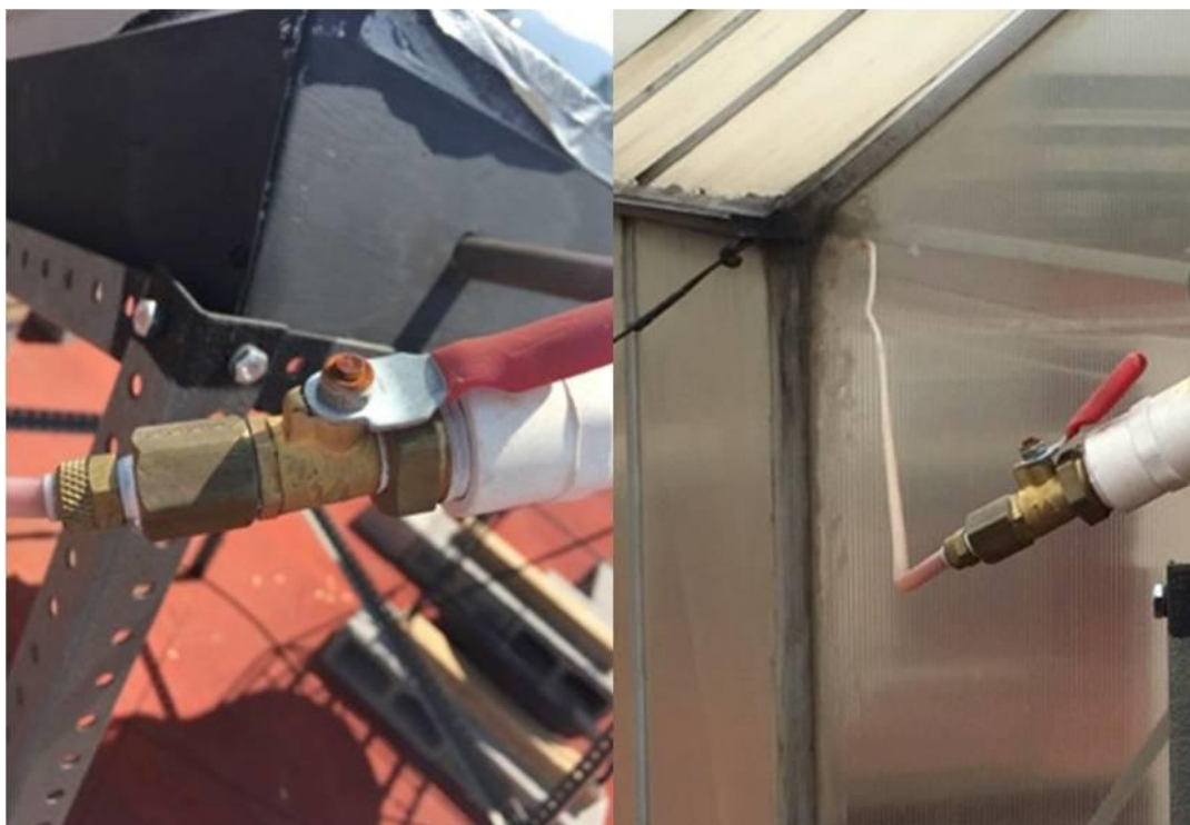
Figura 3.13: Conexión cabezal ½" a válvula ¼" con llegada a caseta.
