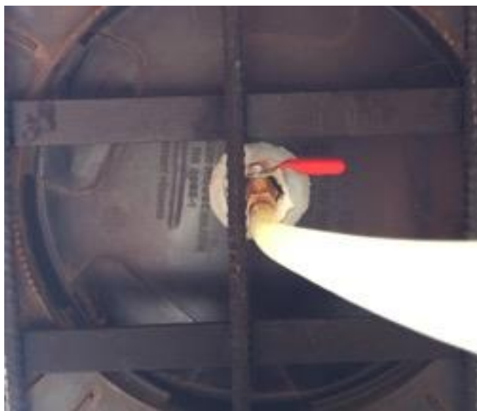
Figura 3.11: Válvula tanque hacia colector solar.
