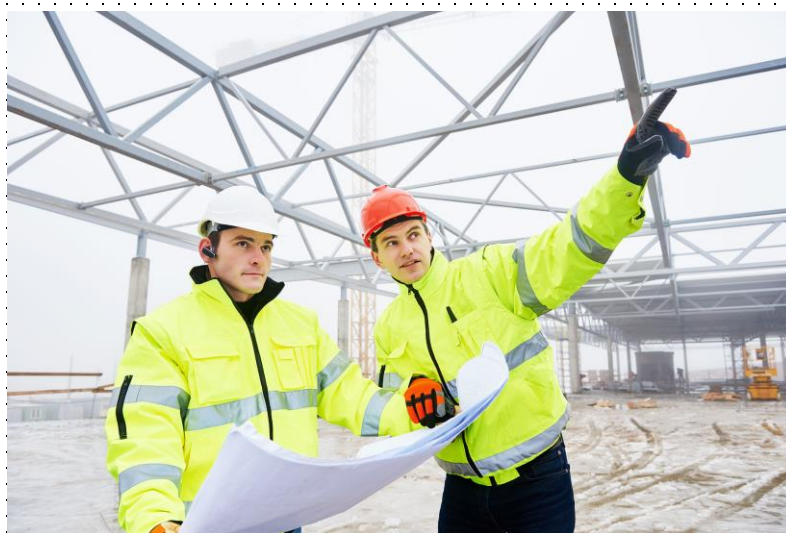
Revisión estructural, Safe on Site.com
