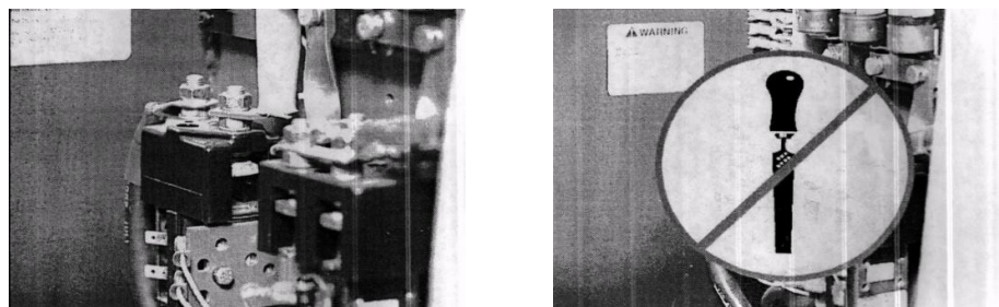
FIGURA 2.8.1.27 PLATINOS DE CONTACTORES
