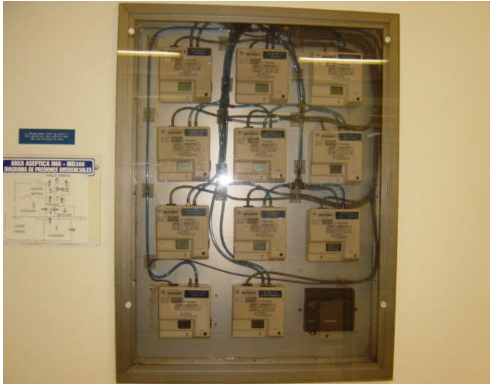
Esquema 3. Tablero de Presiones. Indican y registran la presión en cada cuarto del área de llenado. Cuando salen de especificación se alarma automáticamente.
