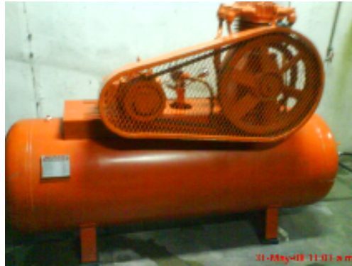
Fig. 2.14 compresor de aire
