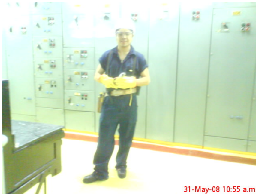
Fig. 1.5 centro de control de motores
