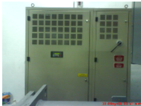
Fig. 2.18 variador de frecuencia
