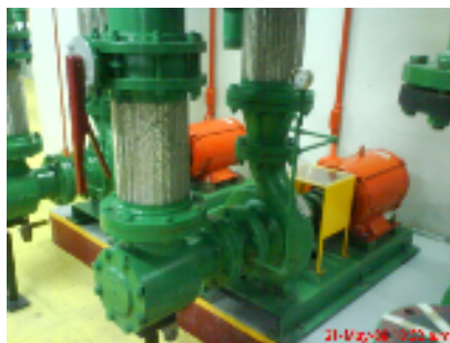
Fig. 2.16 bomba de agua de condensado
