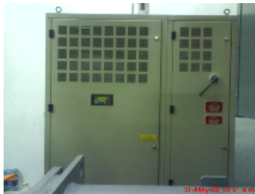
Fig. 4.1 Variador de frecuencia utilizado en los chiller (centrífuga) de cuarto de máquinas
