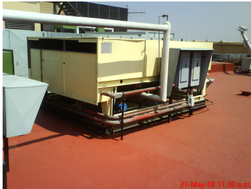
Fig. 1.6 equipos de aire acondicionado
