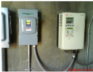
Fig. 2.27 variador de frecuencia
