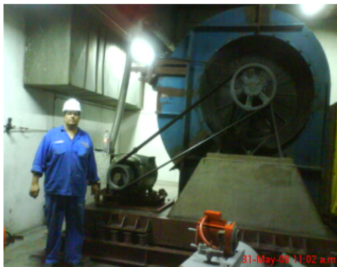
Fig. 2.13 Ventilador de inyección
