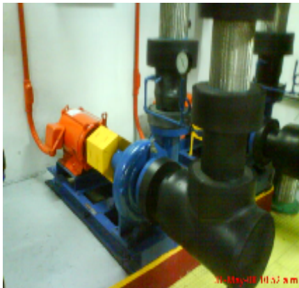
Fig. 2.1 Bomba de agua helada
