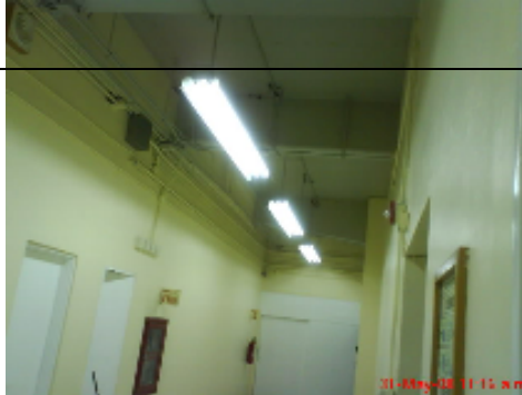
Fig. 2.33 iluminación en pasillos
