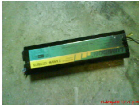
Fig. 4.3 Balastro utilizado anteriormente de 40W ( balastro con chapopote)
