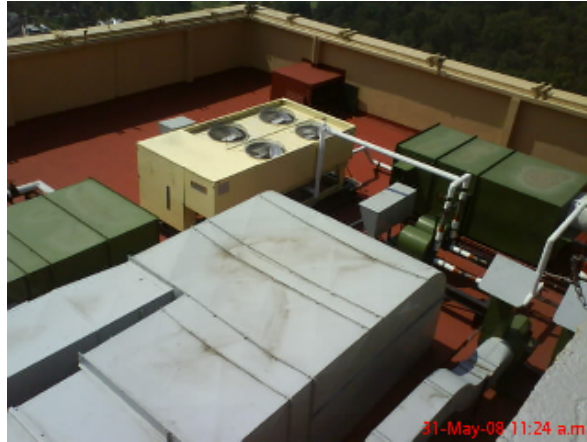
Fig. 2.32 ducteria y condensador
