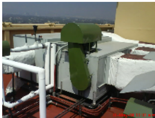
Fig. 2.31 vista de la ducteria y manejadoras
