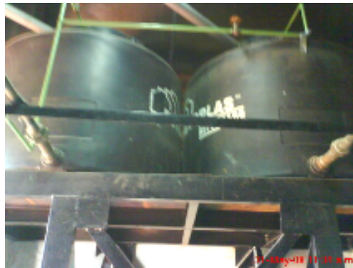
Fig. 2.30 Tanques de reposición de agua de los equipos.
