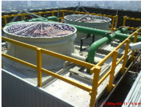
Fig. 2.17 ventiladores de torre de enfriamiento
