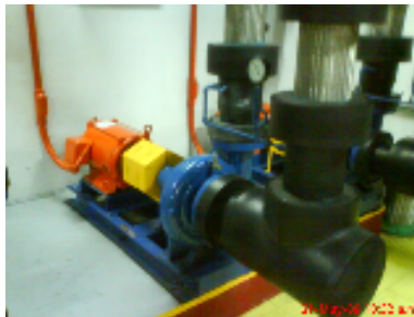
Fig. 2.15 bomba de agua helada
