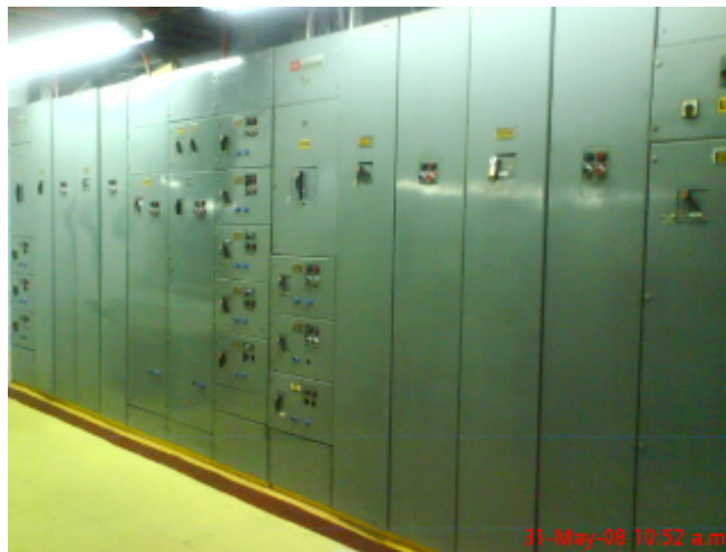
Fig. 2.11 Centro de Control de Motores CCM
