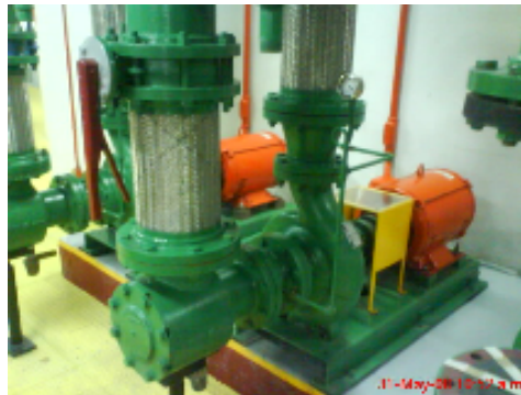
Fig. 1.1 bomba de agua de condensado
