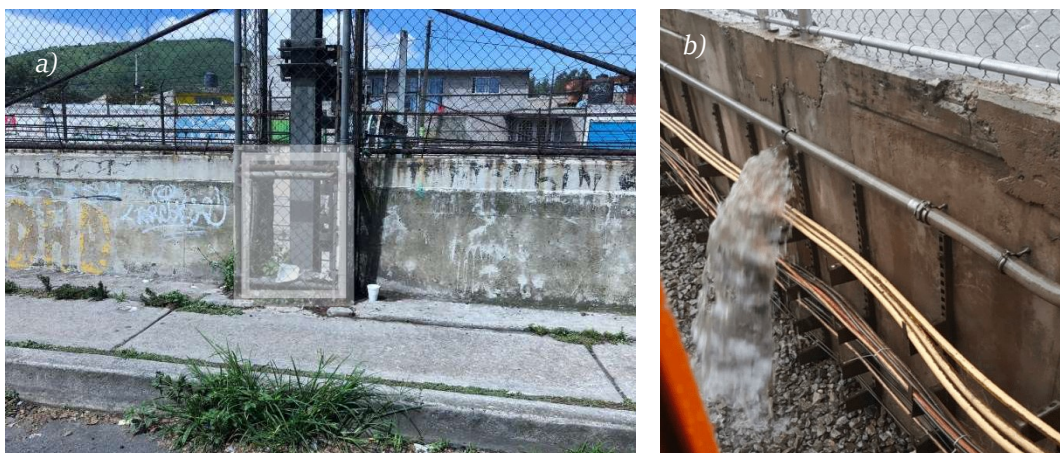
Figura 5.3.4 a) Propuesta de cubierta de orificios b) Falla
