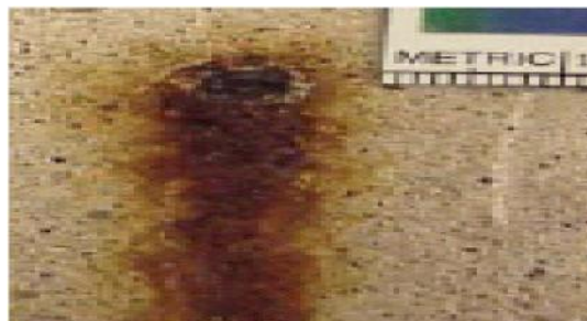
Fig. 2-13. Mancha de óxido de hierro provocada por impurezas en el agregado.
