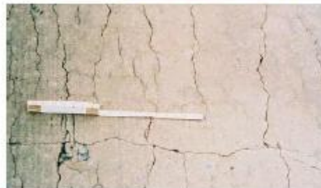
Fig. 2-9. (Superior e inferior). Fisuración del concreto debido a la reacción álcali-agregado.
