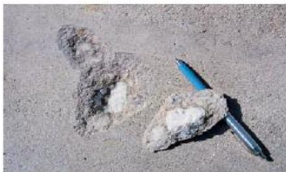
Fig. 2-12. La erupción es el desprendimiento de un pequeño fragmento de la superficie de concreto debido a la presión interna, que deja una depresión típicamente cónica y poco profunda.
