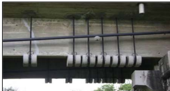
Figura 3.2-2. Uso de presfuerzo vertical para incrementar la capacidad a cortante de las nervaduras. (Jara et al., 2010).
