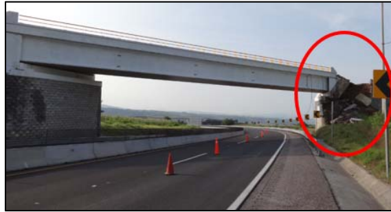
Figura 1.4-24. Daño en puente carretero de Morelos, presentando falla por asentamiento de estribos. (Rivera, 2017).
