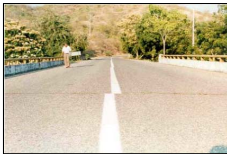
Figura 1.4-1. Desplazamiento transversal en superestructura. (Hernández, Campos, 2008).
