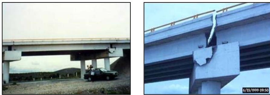
Figura 1.4-10. Daños en topes laterales ubicados en las esquinas que forman el ángulo agudo de un puente esviado. (Jara et al. , 2006).
