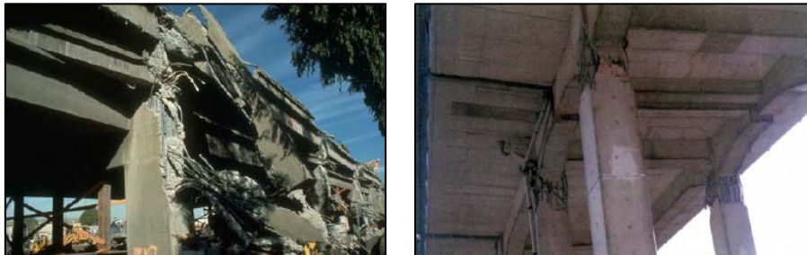
Figura 1.4-21. Falla de cabezal y unión pila-cabezal. (Caltrans, 2006).
