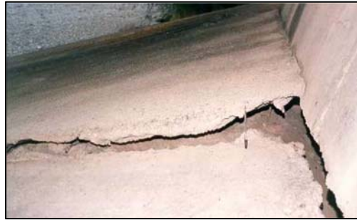
Figura 1.4-14. Asentamiento en terraplén de acceso. (Hernández, Campos, 2008)
