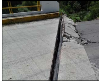
Figura 1.4-6. Desplazamiento de junta debido al asentamiento y rotación de estribo, sismo México, 2017. (Rivera, 2017)
