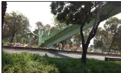
Figura 1.4-9. Pérdida de apoyo en puente peatonal, sismo de México, 2017. (Rivera, 2017)
