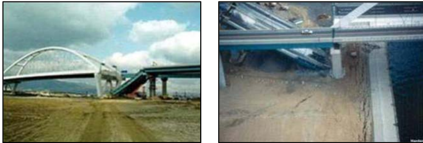
Figura 1.4-8. Derrumbe del acceso al Puente Nishinomiya-ko sobre la vía rápida de Wangan. (Jara et al. , 2006).
