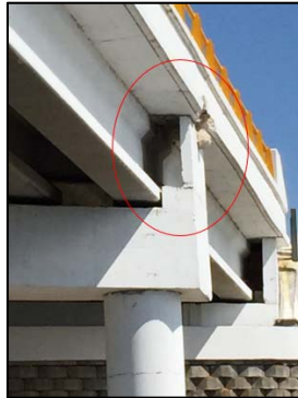
Figura 1.4-12. Falla de tope sísmico en puente de Morelos, sismo de México, 2017. (Rivera, 2017).
