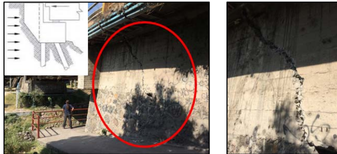
Figura 1.4-25. Fisuras presentadas por rotación y asentamiento de estribo en puente carretero de Morelos. (Rivera, 2017)
