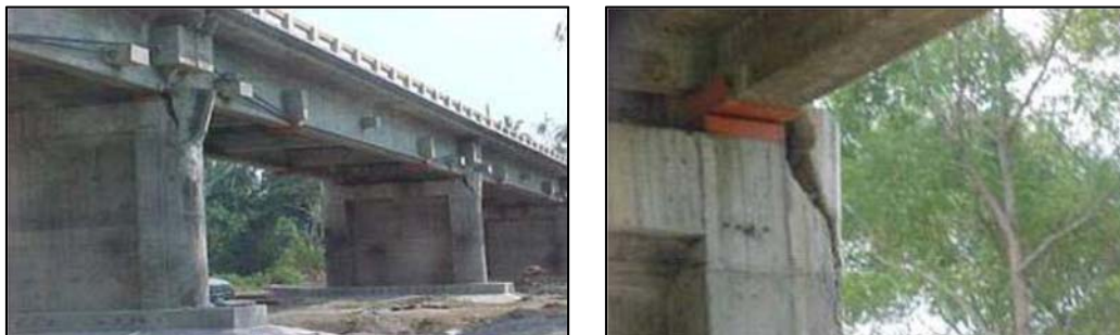
Figura 1.4-11. Daño severo en topes laterales del puente Coahuayana, sismo de Manzanillo de 1995. (Jara et al. , 2006).
