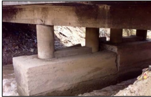
Figura 1.4-26. Falla de cimentación. (Tomado de: Puente universitaria blogspot)
