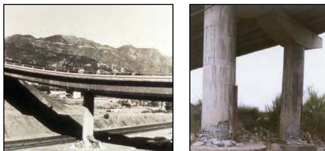
Figura 1.4-15. Falla de columnas por resistencia inadecuada a flexión (Caltrans, 2006).
