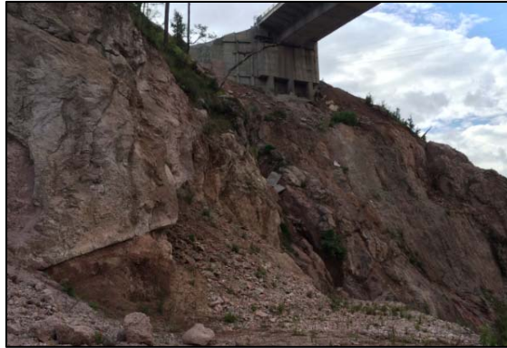
Figura 5.2-4. Deslizamiento del material generado por la mala calidad del material empleado en el terraplén de acceso. (Rivera, 2017)
