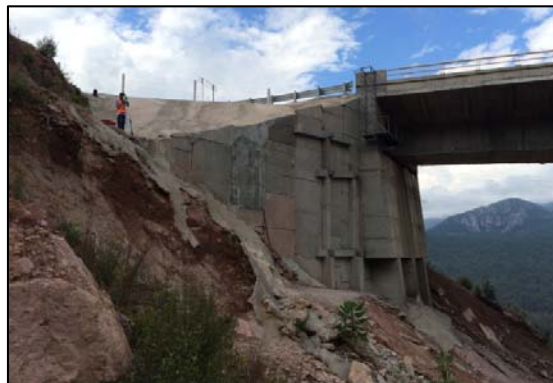
Figura 5.2-3. Desprendimiento de escamas. (Rivera, 2017)
