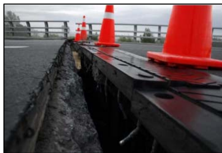
Figura 1.4-5. Junta de dilatación con daño tras terremoto. (PREANSA, 2010)
