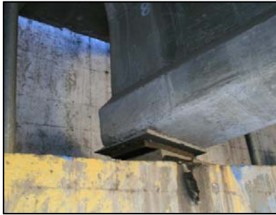
Figura 1.4-3. Apoyo desplazado durante el sismo de 2010, Chile. (González, 2016).
