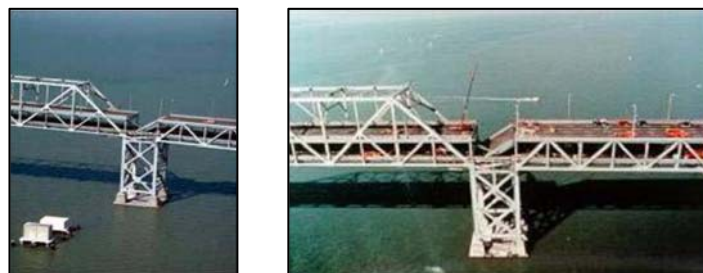
Figura 1.4-7. Colapso de una sección de la superestructura del Puente de la Bahía Oakland-San Francisco, sismo de Loma Prieta en 1989. (Jara et al., 2006)
