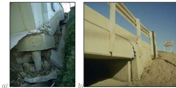
Figura 1.4-13. a) Deslizamiento de un terraplén de acceso. b) Asentamiento de un terraplén de acceso. (Quiroz, Ayala).
