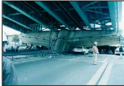
Figura 1.4-20. Colapso del viaducto Takashio, sismo de Kobe 1995. (Amini et al., 2010)
