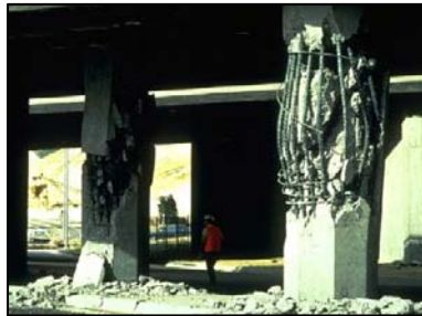
Figura 1.4-16. Falla por falta de refuerzo transversal de confinamiento en columnas (Priestley et al., 1996)
