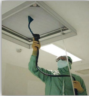
Figura 104. Prueba de Integridad de Filtro HEPA
