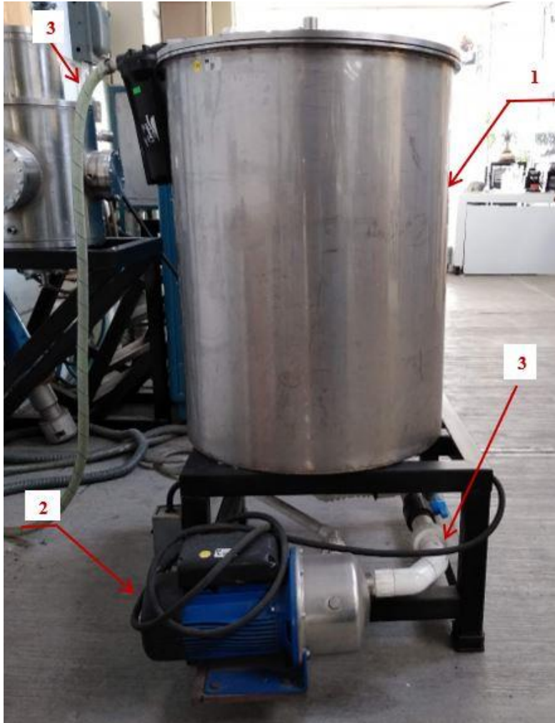
Figura 11. Fotografía tomada a sistema de refrigeración por circulación forzada de agua. Se puede observar a los elementos que componen al sistema.
