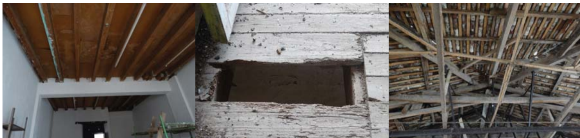
FIG. 103 DETERIOROS DE PISOS Y CUBIERTA DE LA SECCIÓN B, DE LA ESCUELA "LA ENSEÑANZA".
