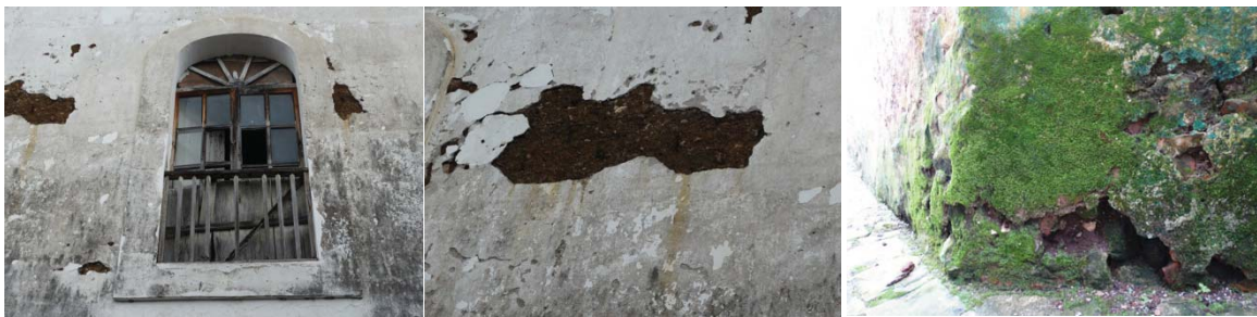
FIG. 102 DETERIOROS EN MUROS DE ADOBE DE LA SECCIÓN B, DE LA ESCUELA "LA ENSEÑANZA".
