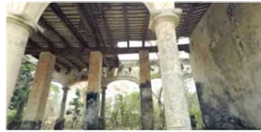
FOTOGRAFÍA 5 Vista interior Casa de Máquinas
