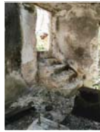
FOTOGRAFÍA 3 Vista interior del cuarto de Diesel
