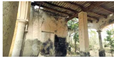
FOTOGRAFÍA 8 Vista interior Casa de Máquinas
