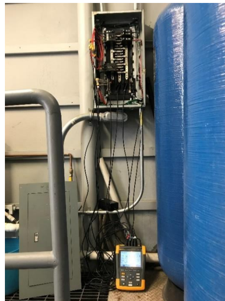
Figura 42. Medición del consumo de energía eléctrica del sistema de ozonización.
