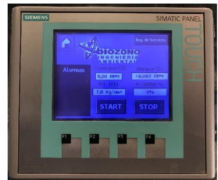
Figura 16. Panel de control automático.
