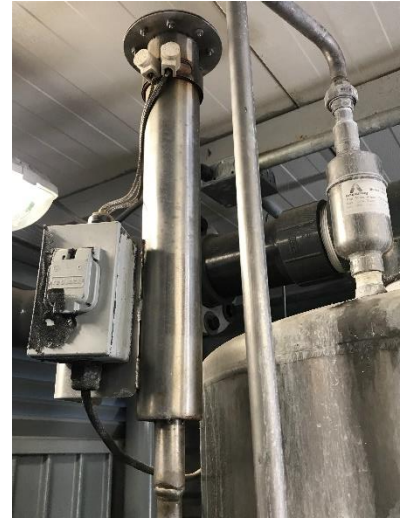
Figura 15. Destructor de ozono.
