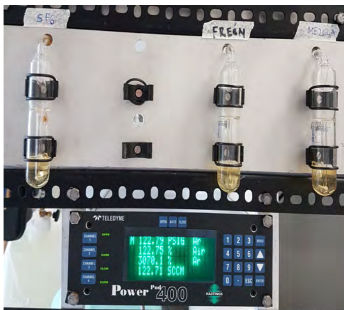
Figura 3.17: Panel frontal del sistema de suministro de gas.
