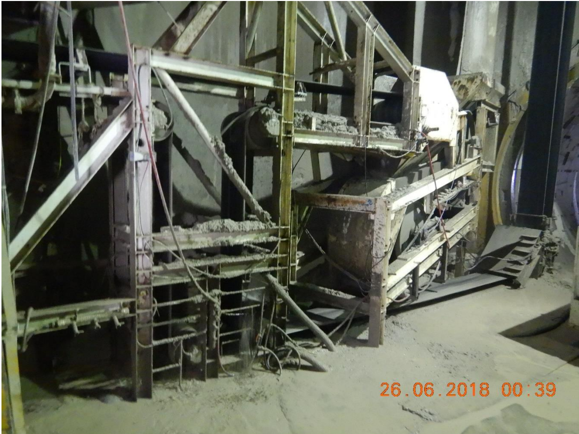
Figura 289. Caída de rezaga en fondo de lumbrera por mal acondicionamiento.
