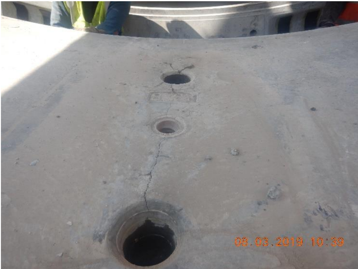
Figura 311. Daño por fractura en dovela.
