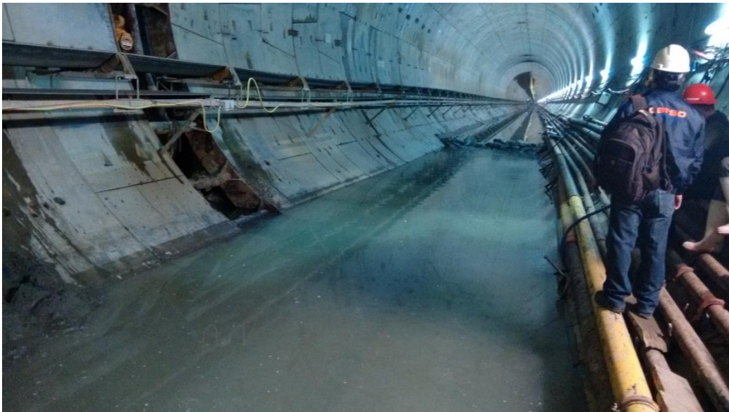
Figura 328. Riego de inundación en túnel.
