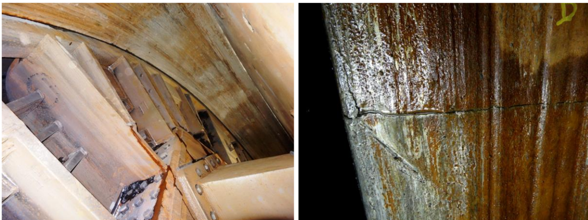
Figura 264. Daño presentado en cámara de excavación.
