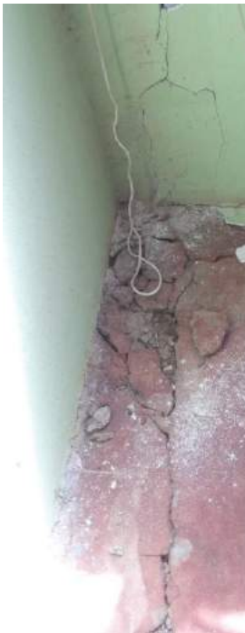
Imagen 17. Piso de la vivienda levantado a causa del sismo
