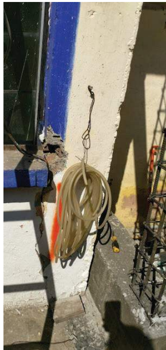
Imagen 18. Falla en muro.
