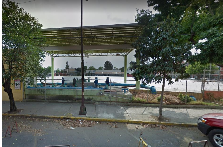
➤ Depósito y bombeo de agua El Arbolillo I SACMEX
