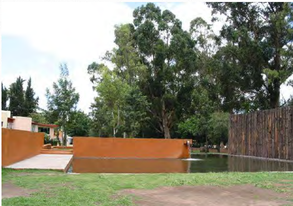
Fuente del Campanario de Luis Barragán, con el paso de los años fue grafitada y presenta cuarteaduras y humedad. Fuente: AngelFire.com. 50.
