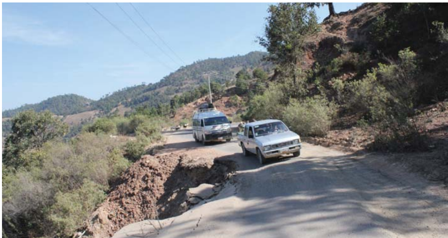
Fotografía por Roman Zemánek, derrumbe en la carretera
