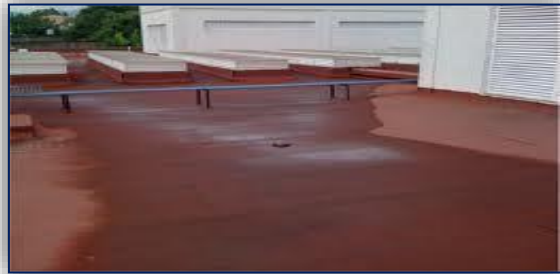
Figura 2.2.- Azotea con agua encharcada
