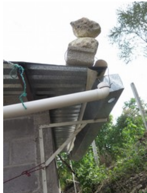
Figura 35: Sistema de captación de lluvia de techo de chapa
