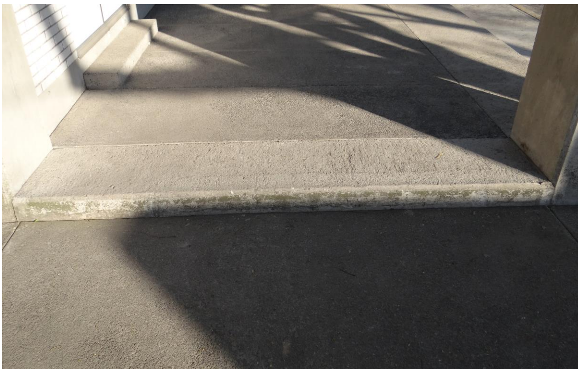
Foto 13. Escalón de 6cm en pasillo de la UBIMED.
