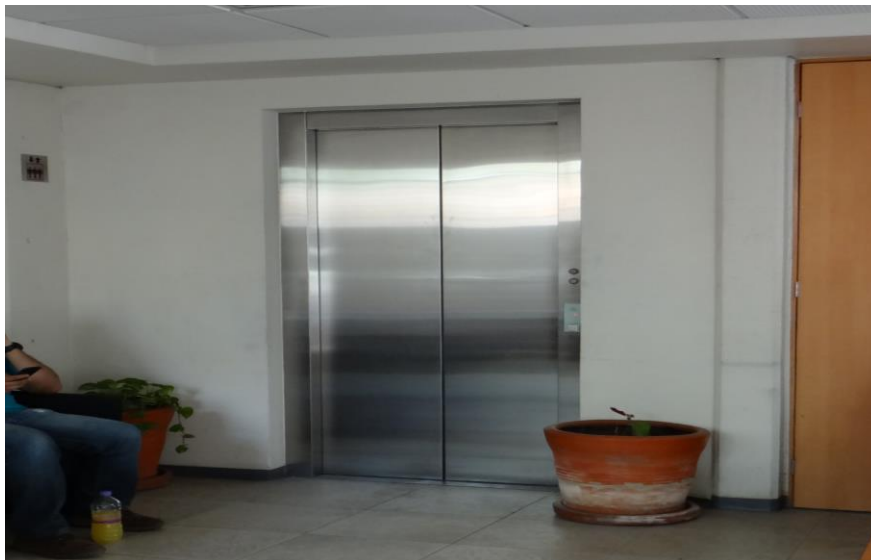
Foto 10. Elevador de la Torre de Tutorías.
