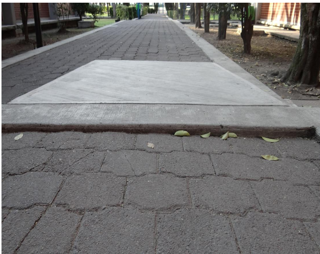
Foto 22. Desnivel en el adoquín.
