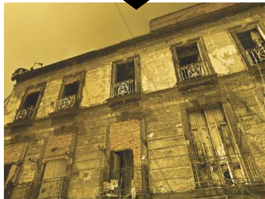
Fig. no. 34 (Abajo). Fachada, muestra cancelación de vanos y estado de ruina.
