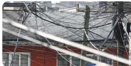
ROBO DE LUZ, UN PROBLEMA MUY COMÚN EN LAS VIVIENDAS DE LA CIUDAD DE MÉXICO. (I.17)
