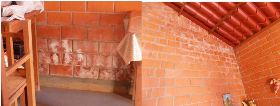
Casas de Adoblock con humedad (2014). Ricardo Velasco
